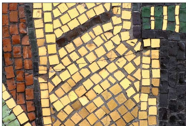
Obr. 23: Praskliny v mozaikových kostkách, vzniklé pravděpodobně následkem nárazu těžkého předmětu do plochy mozaiky (foto archiv FR UPa, 2017).
