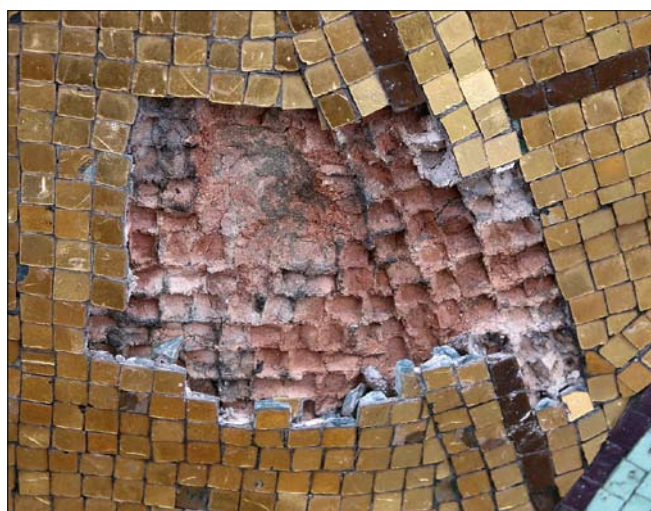
Obr. 17: Otevřený defekt v ploše mozaiky s odhalenou původní osazovací maltou.
