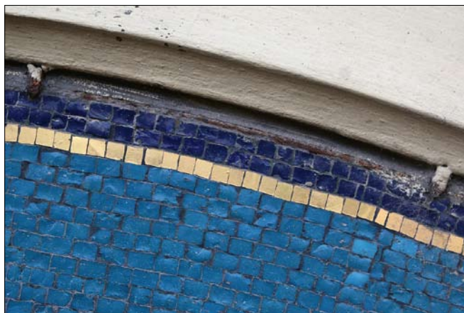
Obr. 20: Koroze kovového rámu mozaikového panelu Vítězný Kristus.
