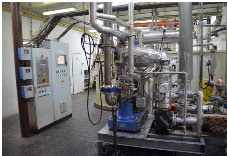
obrázek č. 4 – koloidní mlýn IKA společnosti Vialit Soběslav, s. r. o., vlevo automatický řídicí systém pro ovládání vodní fáze a řízení výroby [20]
