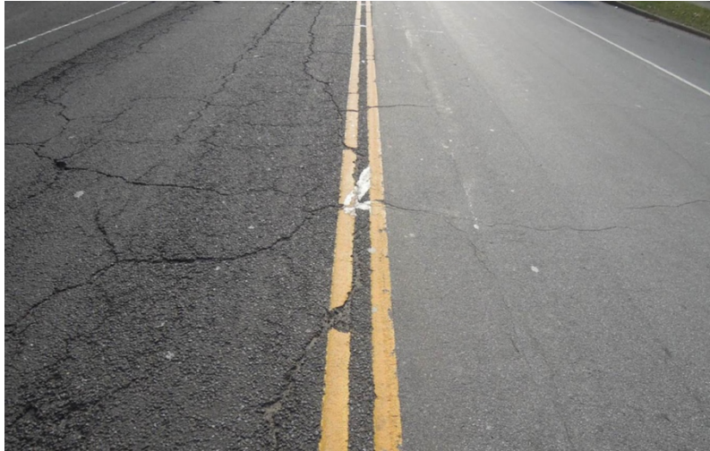
obrázek č. 21 – porovnání – vlevo metoda MILL and FILL, vpravo úprava EMK, foceno po 4 letech provozu [26]
