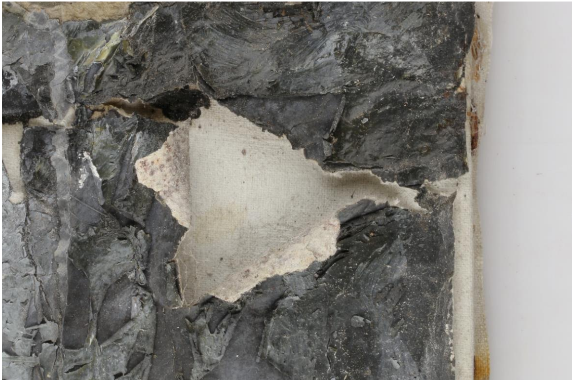
Obr. 75 Detail trhliny, před restaurováním
