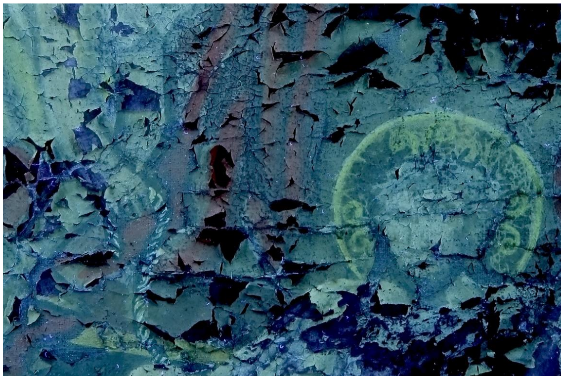
Obr. 5 Detail degradované povrchové úpravy před restaurováním, UV záření
