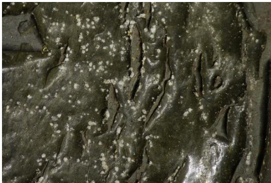
Obr. 17 Detail mikrobiologického napadení v trhlíně, pozorování
