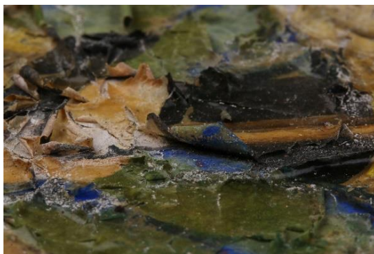
Obr. 9 Detail degradované povrchové úpravy, před restaurováním
