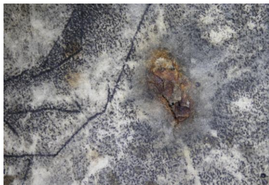
Obr. 20 Korozní produkt v papírové podložce
