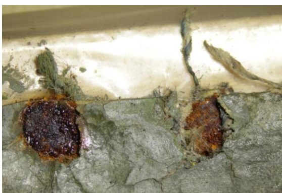
Obr. 19 Vypínací hřebíky s korozními produkty z lice díla
