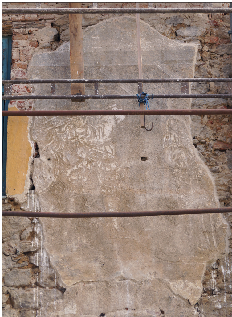
Obr. 132 Výjev s muzikanty – stav po odkryvu, očištění, konzervaci a obtmelení.
