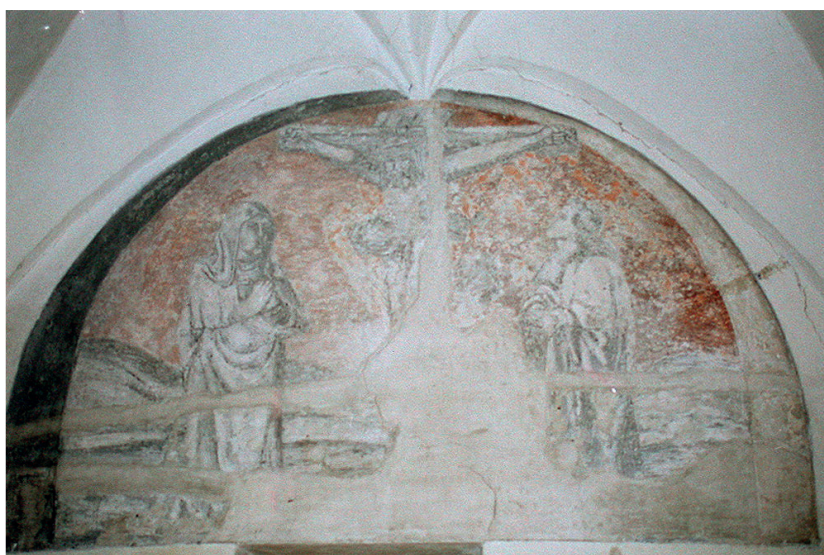
Obr. 6 Slavonice, dům čp. 58 – bývalá poštovní stanice, první patro. Stínované sgrafito s červeně kolorovaným pozadím před restaurováním
