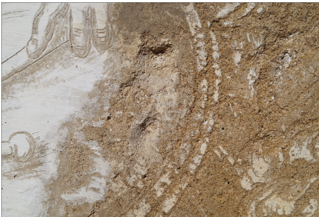
Obr. 173 Drobná poškození, která bylo nutné vytmelit z technických důvodů (průnik vody do materiálu).
