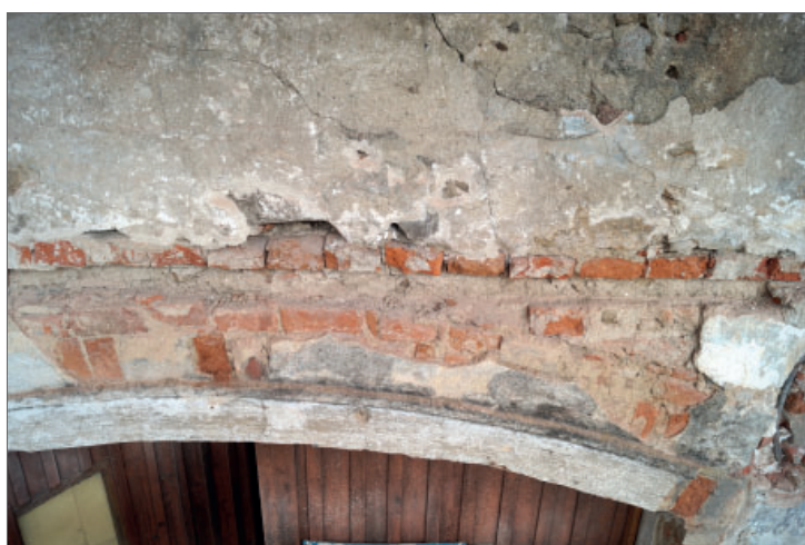
Obr. 71 Fasáda do ulice Boženy Němcové – fragmenty odsekané renesanční profilované římsy a postranních bos.
