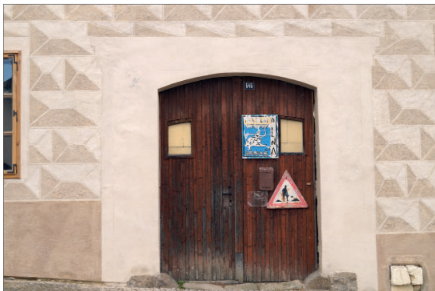
Obr. 70 Fasáda do ulice Boženy Němcové – naznačené obrysy renesančního portálu po restaurování v ryté lince.
