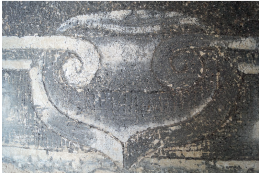
Obr. 17 Slavonice, Horní nám., dům čp. 520. Detail původního povrchu na dekoru stínovaném odebráním špachtlí (prokletováním bianca). Barevné intonaco je probarveno dřevěným uhlím.
