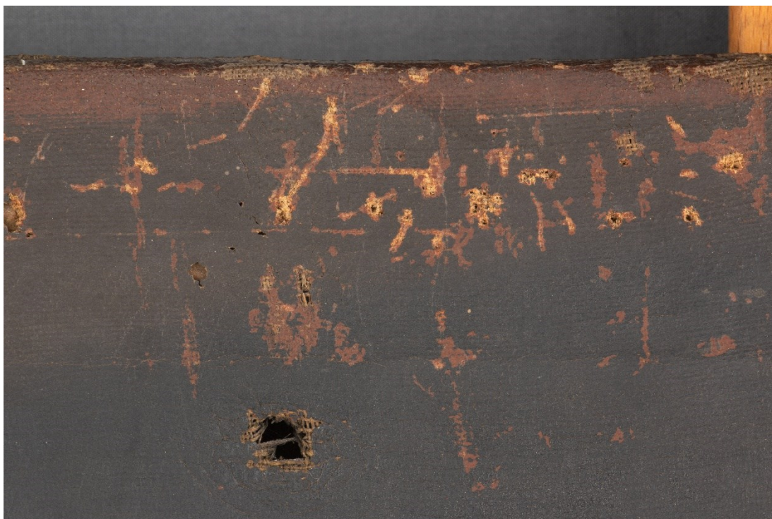
Obr. 2. 6 Stav díla před restaurováním, detail poškození v horní části díla
