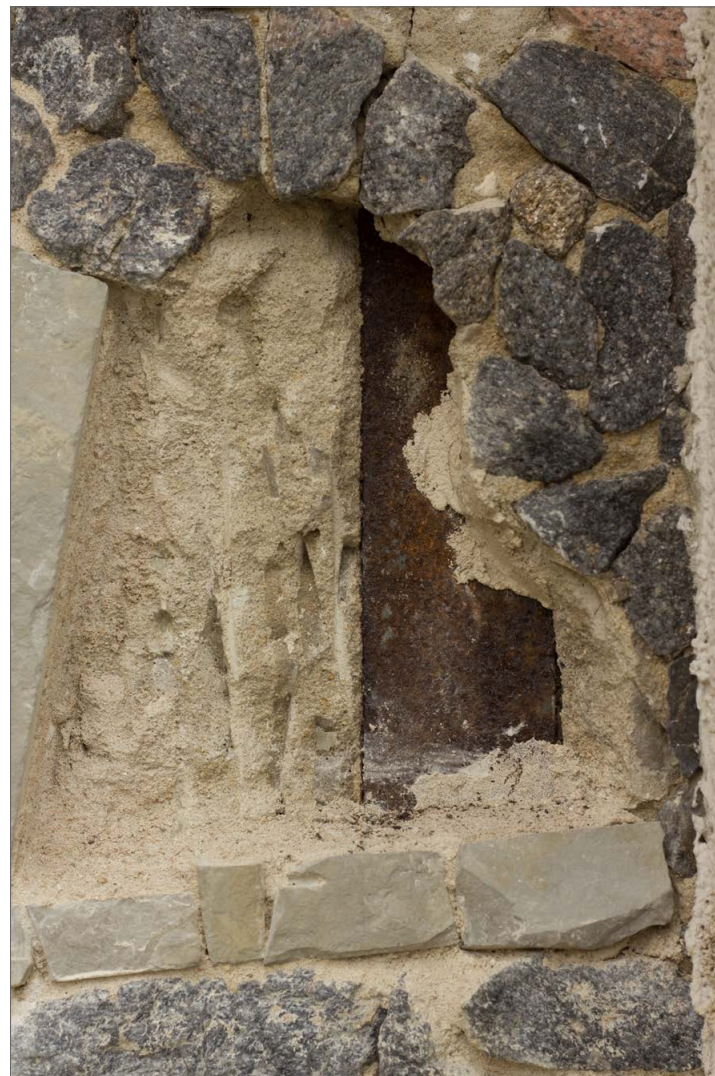
Obr. 87: Kamenná mozaika Ptačí rodina – detail obnažené ocelové armatury ve střední pravé části mozaikového výjevu.
