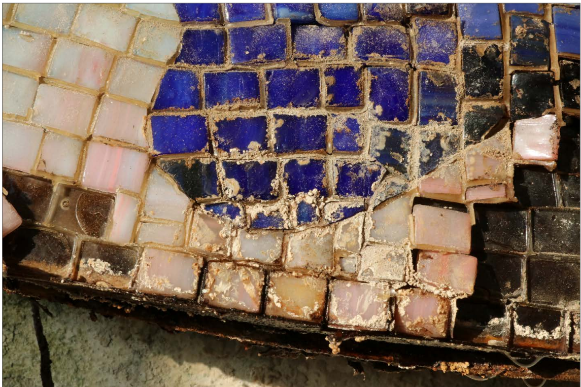
Obr. 51: Skleněná mozaika s motivem racka – detail dolní části mozaikového výjevu – bílé usazeniny, korodovaný ocelový rám, úplná ztráta mozaikových kostek.
