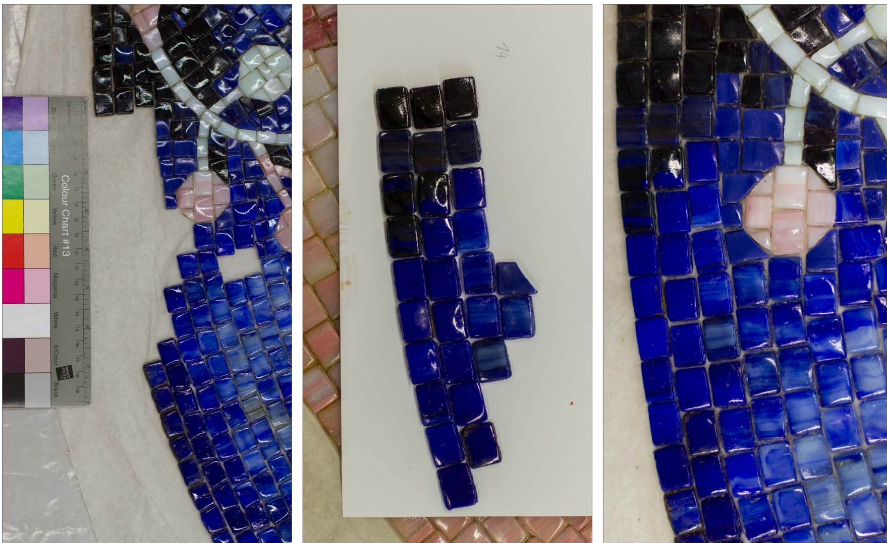
Obr. 65: Skleněná mozaika s motivem racka – postup doplnění chybějících částí mozaiky u defektu č. 14 – (zleva) místo se ztrátou kostek, připravený díl s doplňkem, místo po provedení rekonstrukce.
