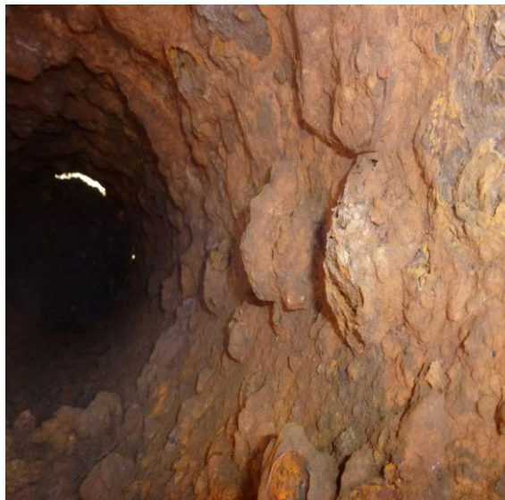
Obr. 32 fotografie koroze na vnitřní straně potrubí
