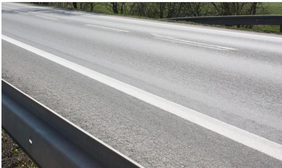
Obr. 25 Detail silnice I/38 – zvlnění povrchu (vyjeté koleje)
