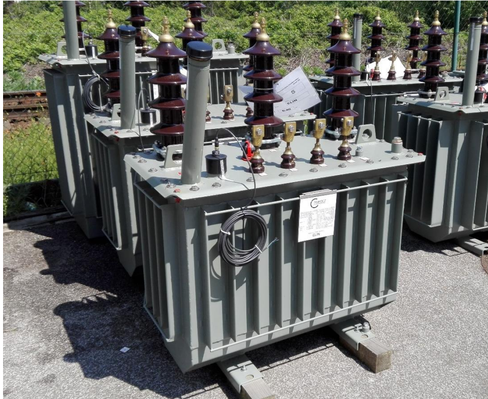
Obr. 7 Distribuční transformátory s převodem 35/0,4kV o výkonu 160kVA
