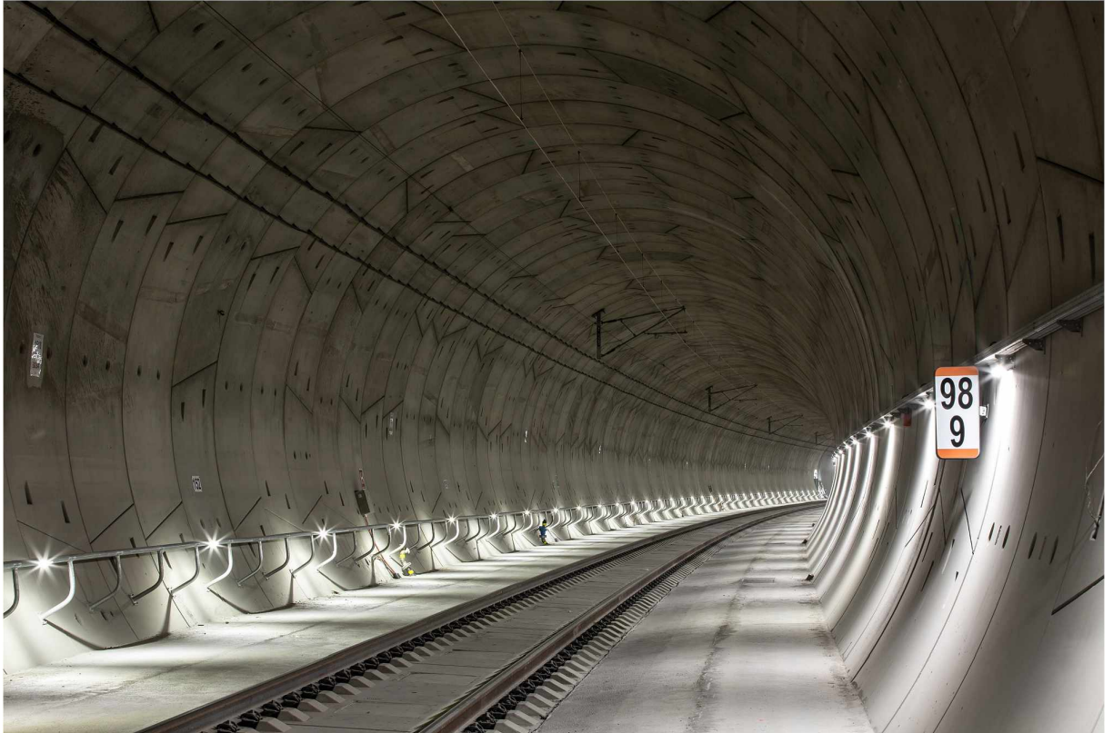
Pevná jízdní dráha v dokončeném tunelu (2019, foto archiv autora)
