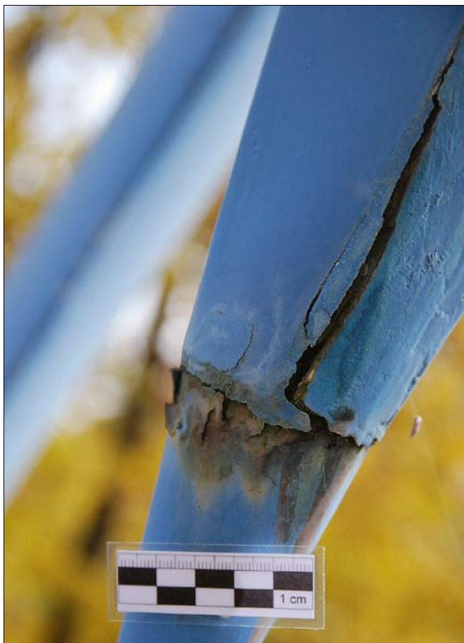
Obr. 7: Detail poškození – trhliny se stopami produktů koroze vnitřní konstrukce, snímek z roku 2015 (foto J. Červinka).
