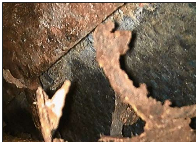
Obr. 9: Endoskopický průzkum – koroze vnitřní konstrukce, snímek z roku 2015 (foto M. Tkáč).
