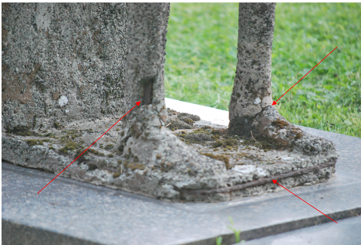
Poškození na plintu a nohou
