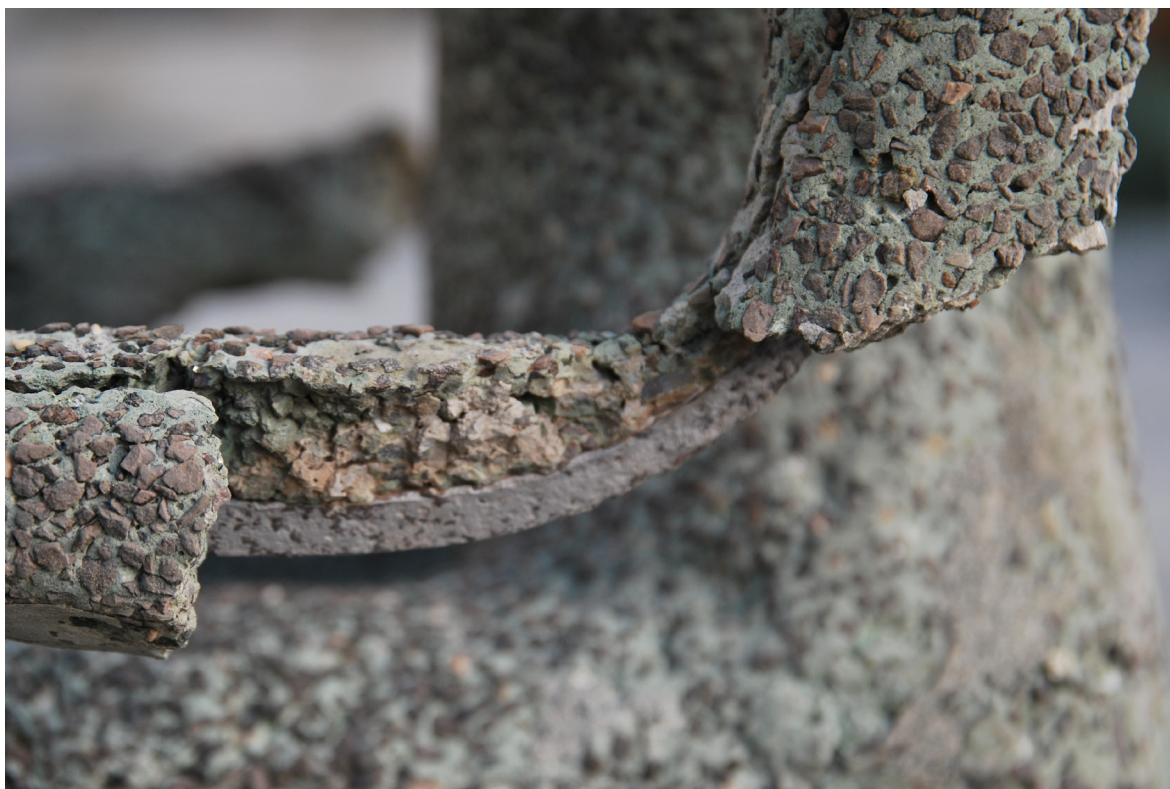
Obnažená výztuž po otryskání
