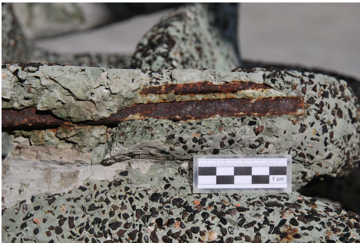
Obnažená zkorodovaná výztuž
