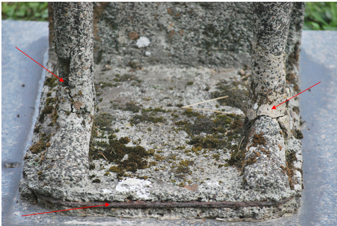
Obnažená zkorodovaná armatura na plintu sochy, destrukce betonu v kotnících
