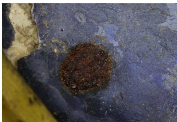
Obr. 23 Detail hřebíku s korozními produkty (zvětšeno 20×)
