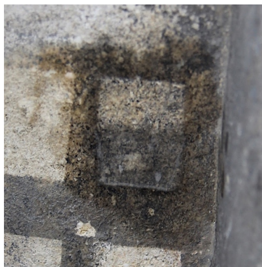
Obr. 31 Horní část zkušební plochy očištěná po pěti minutách působení uhličitanu amonného v gelu
