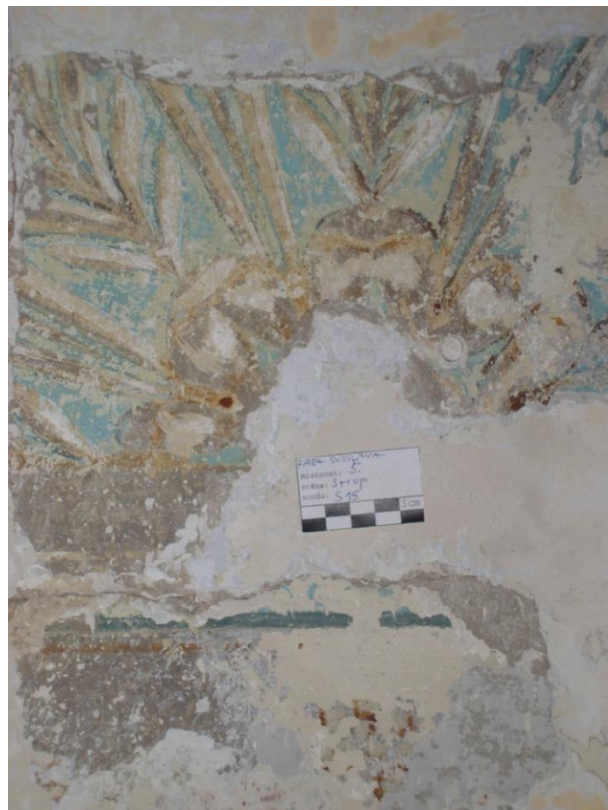
Příloha č. 13: Výmalba z 2. poloviny 19. století v části, kde se dnes nachází sociální zařízení
