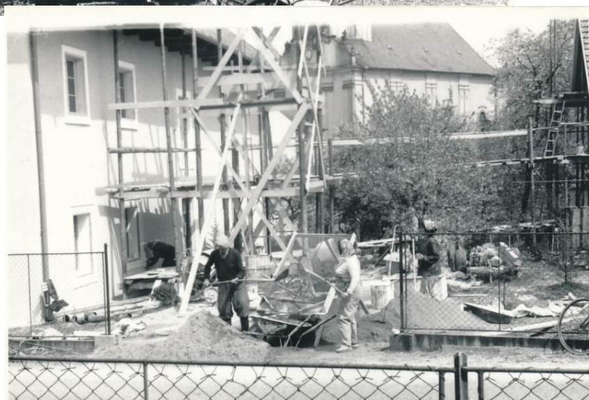
Příloha č. 4: Obnova fasády v roce 1974, na fotografii je vidět balkon se suchým záchodem, který byl zbourán z důvodu špatného stavu a podmáčení zdiva.
