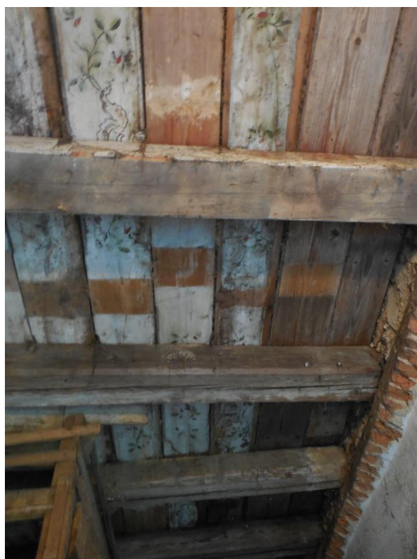
Příloha č. 20: Barokní záklop v hospodářském stavení před demontáží
