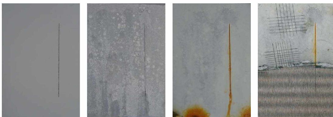
Nátěrové filmy s obsahem WS_2/PANI OKP=1 % před expozicí, po 120 hodinové expozici, po 1848 hodinové expozici, ocelový panel po odstranění nátěrového filmu
