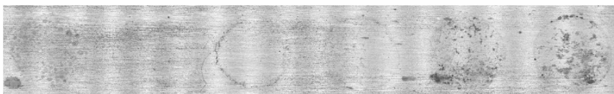
Po expozici 720 hodinách, po odstranění nátěru
