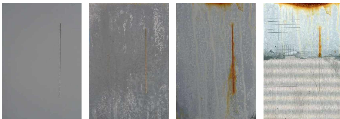
Nátěrové filmy s obsahem ZnS/PANI OKP=5 % před expozicí, po 120 hodinové expozici, po 1848 hodinové expozici, ocelový panel po odstranění nátěrového filmu
