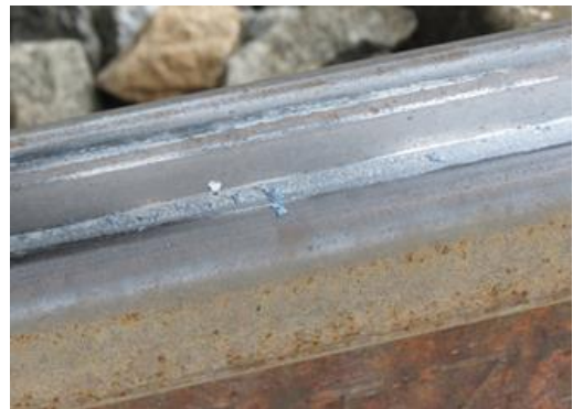
Obrázek 3 – poškození kolejnic – poskytnuto firmou DAKO-CZ
