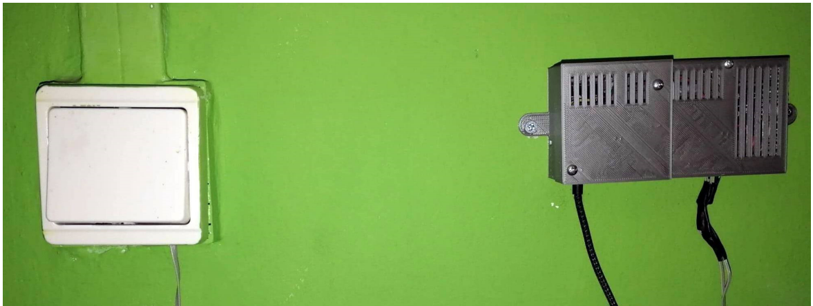
Obr. 1.11 – Umístění jednotky ovládání světla a měření teploty/vlhkosti
