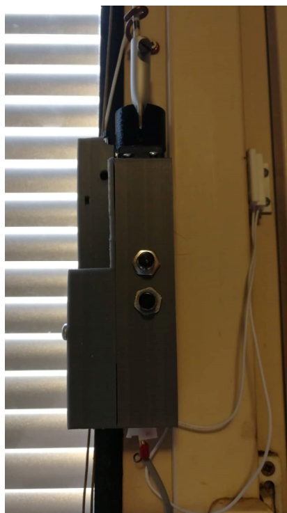
Obr. 2.1 – Místní ovládání žaluzií
