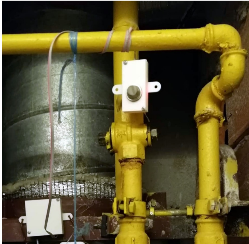
Obr. 1.33 – Umístění jednotky pro detekci úniku zemního plynu
