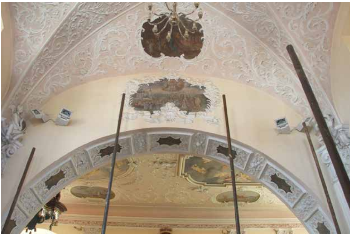
Obr. 4 Celkový pohled na vítězný oblouk oddělující kapli od prostoru hlavní lodi kostela a na jižní stěnu kaple s výjevem zobrazujícím vedutu s klokotským poutním areálem. Stav před restaurováním. Foto: Stavební huť Slavonice, 2015.
