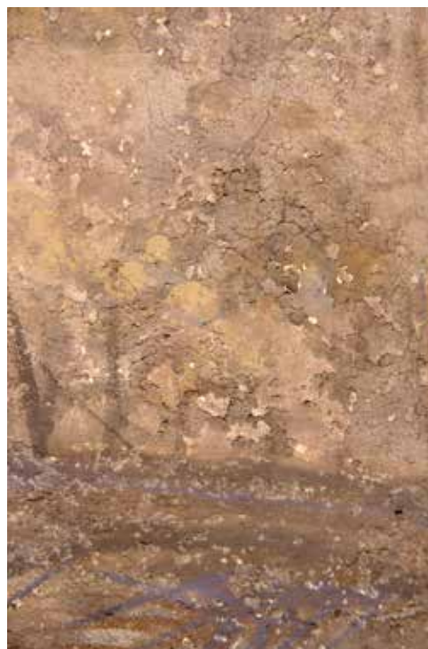
Obr. 5 Sv. Josef a mladý Ježíš nesoucí Arma Christi, detail pozadí v horní části výjevu, dokumentace poškození.
