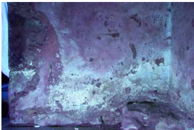
Obr. 8 Příklad srovnání fotografie pořízené v bílém umělém osvětlení a UV fluorescenční fotografie středověkých omítek zasažených působením vodorozpustných solí. Čelní stěna vítězného oblouku, jižní část, kostela sv. Víta v Zahrádce u Ledče nad Sázavou. Foto: Ivana Studeník Milionová.
