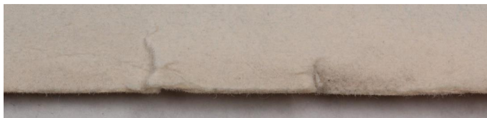
Obr. 21. Detail trhlín, líc, stav před restaurováním, zábleskové světlo
