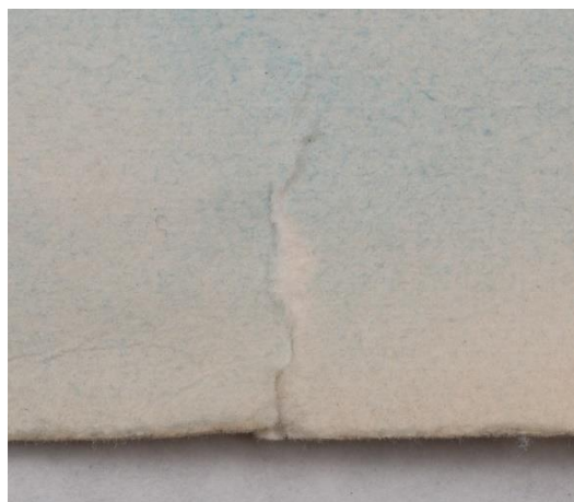
Obr. 19. Detail trhliny, líc, stav před restaurováním, zábleskové světlo
