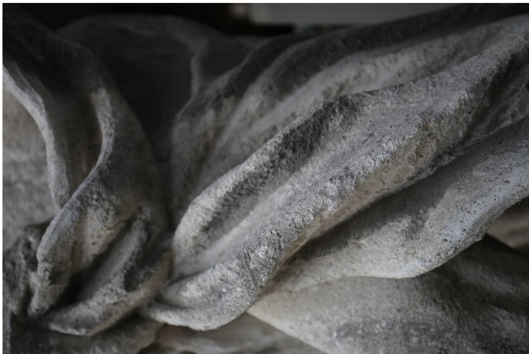
Obr. 53 Stav před čištěním sádrovcové krusty-detail na drapérii
