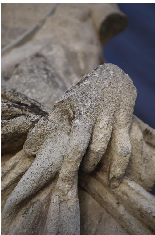
Obr. 75 a.) Stav před restaurováním
