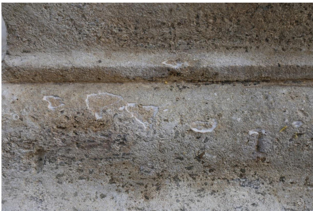
Obr. 103 Postament, průběh restaurování-defekty na povrchu po injektáži
