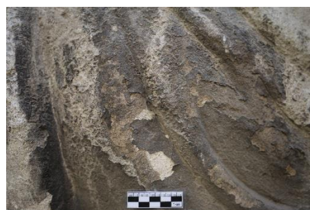
Det. č.8 Sádrcová krusta a delaminace, detail.
