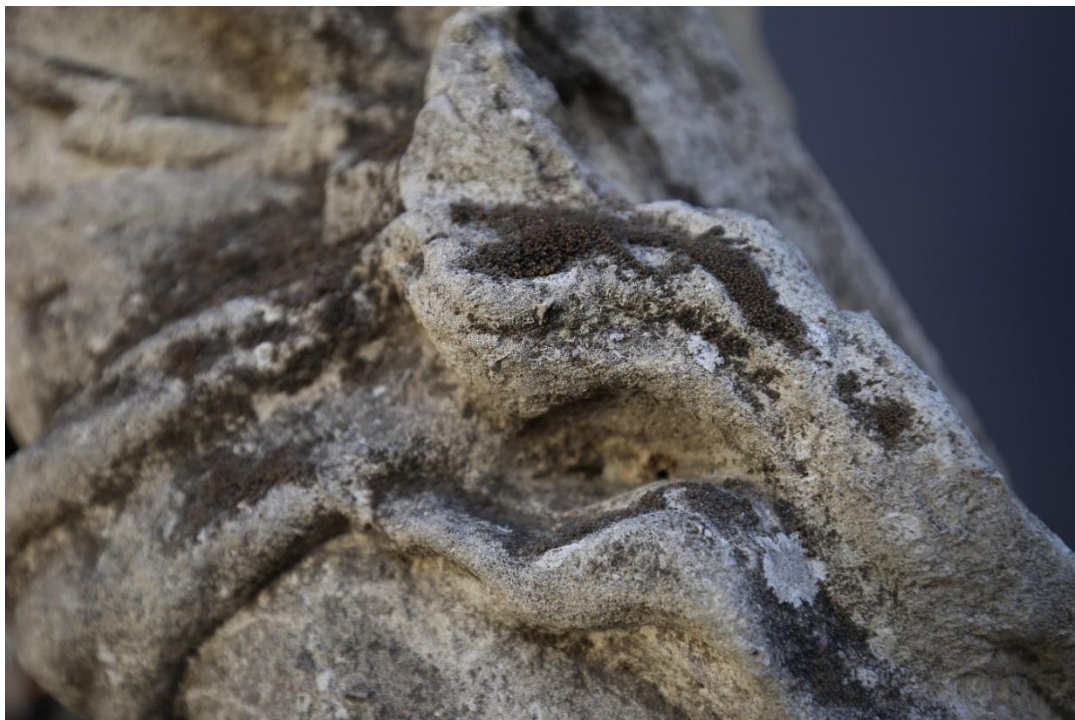
Obr. 59 Stav před očištěním povrchu od biologického napadení-detail na blesky
