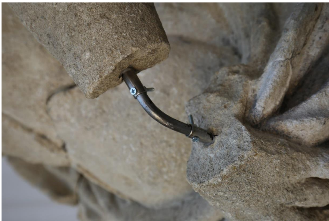
Obr. 63 Kompletování odlomené části-detail na spoj
