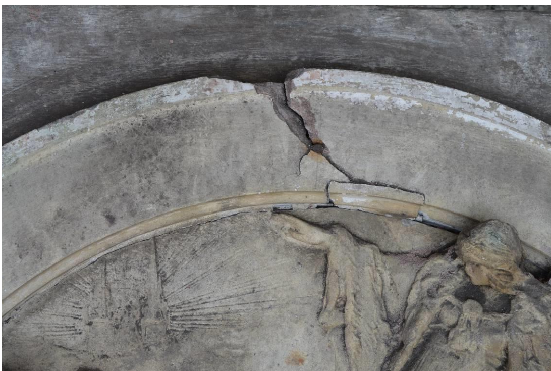
Obr. 43 Detail praskliny, prachový depozit a kovový prvek
