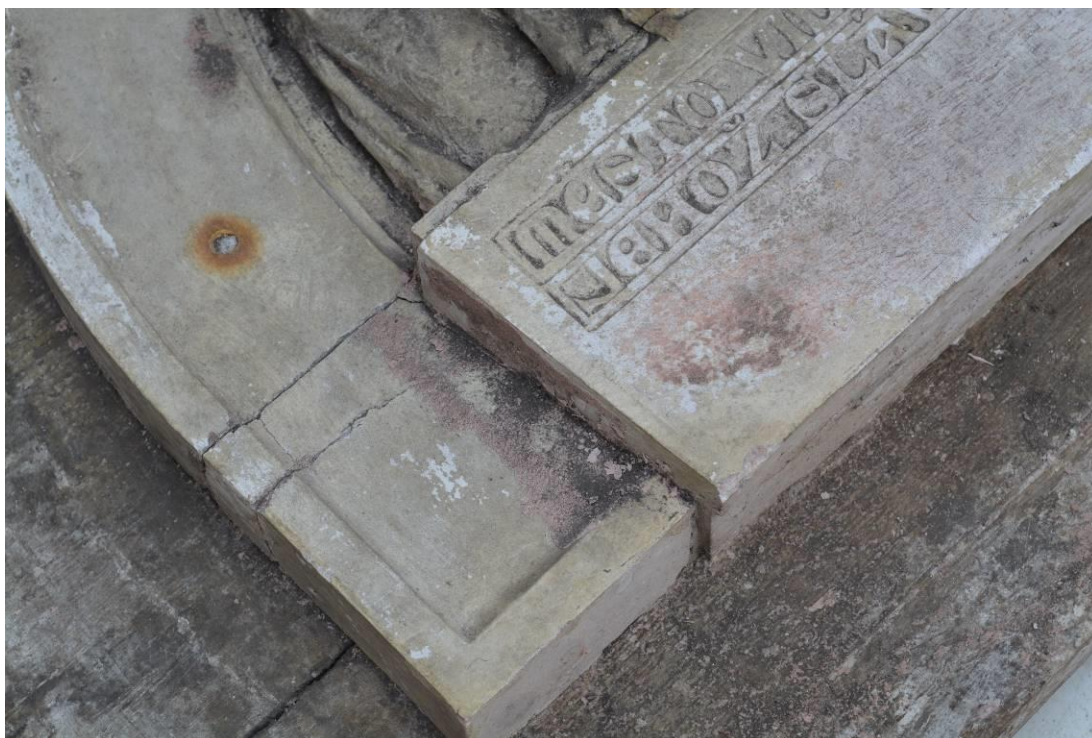
Obr. 46 Oranžové zbarvení způsobené korozi kovového prvku, praskliny, odlupující se povrchová úprava
