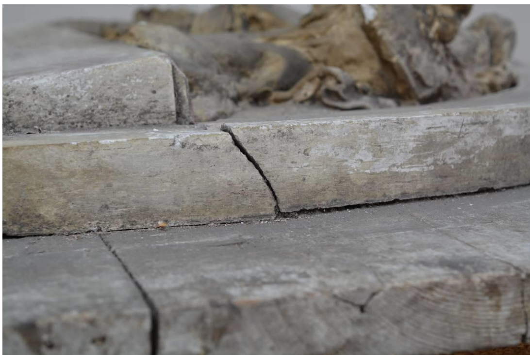
Obr. 45 Prasklina v pravém dolním rohu
