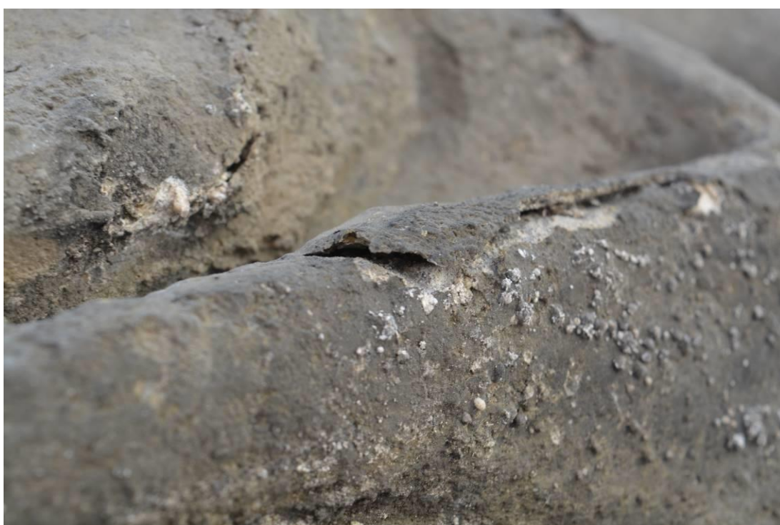
Obr. 14 Stav před restaurováním, oddělující se povrch
