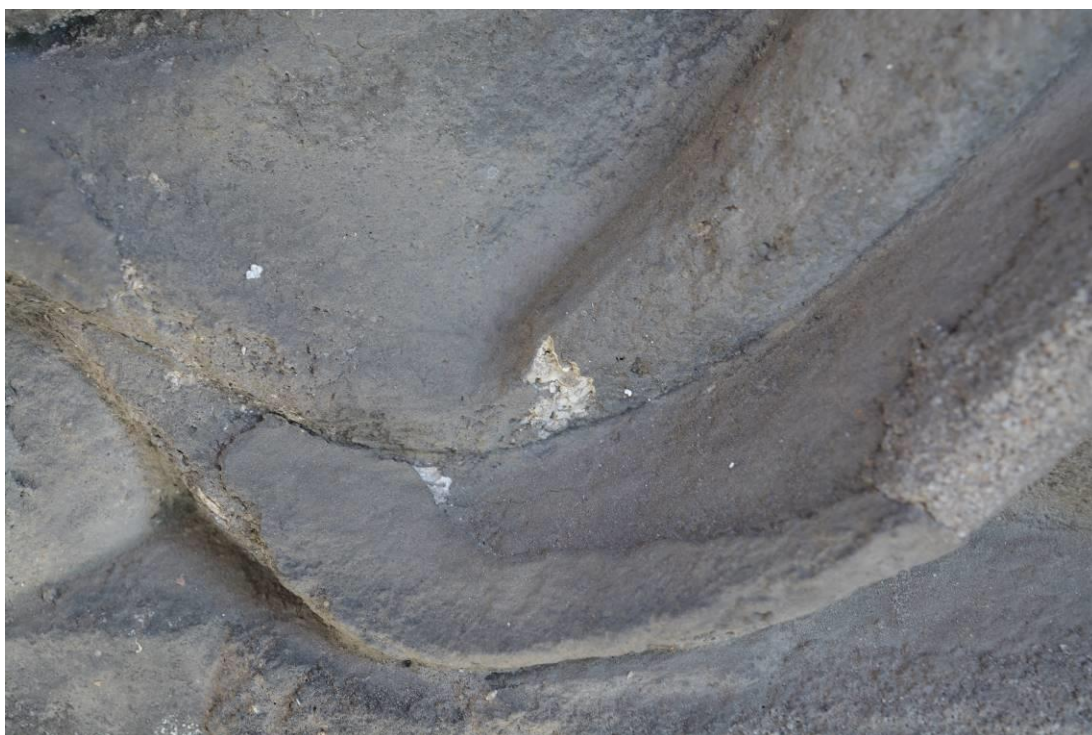
Obr. 12 Stav před restaurováním, starý tmel
