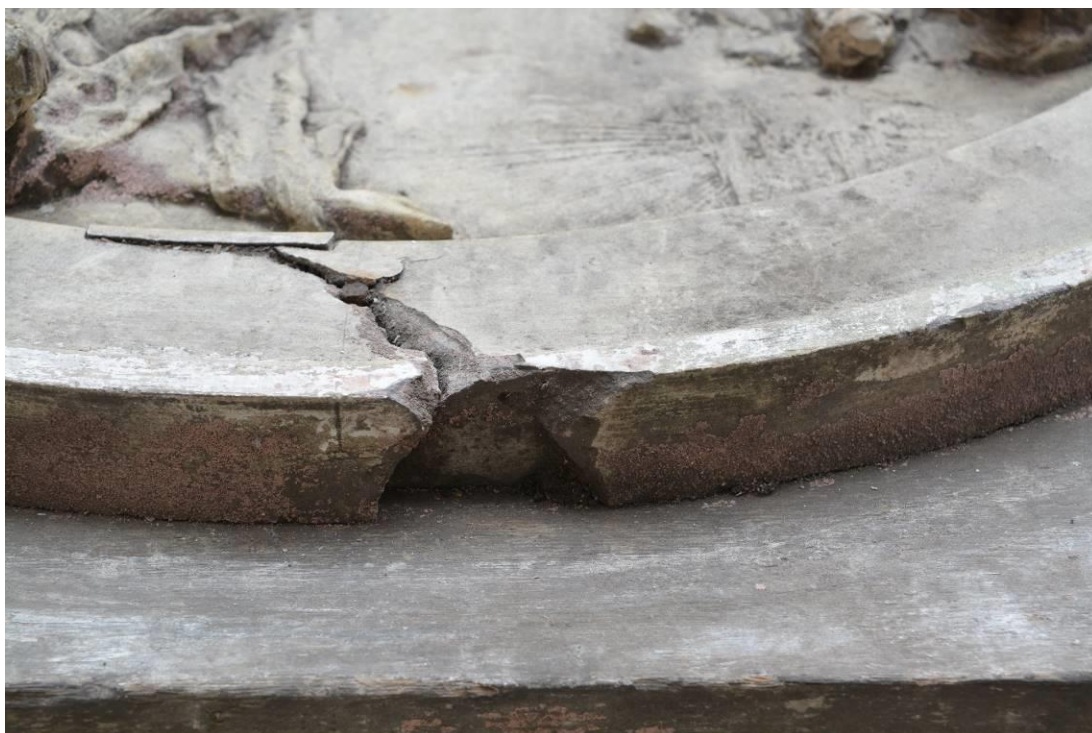
Obr. 44 Prasklina a chybějící část, prachový depozit a růžový protipožární nástřik
