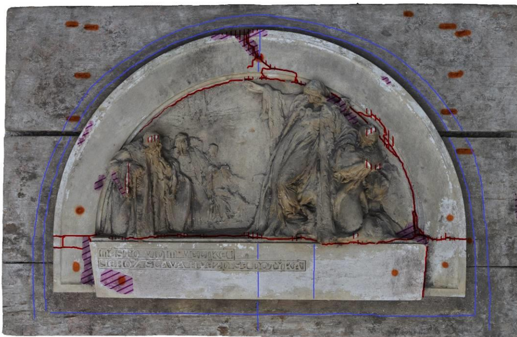
Zákresy prasklin, kovových prvků, protipožárního nástřiku a autorových značek
