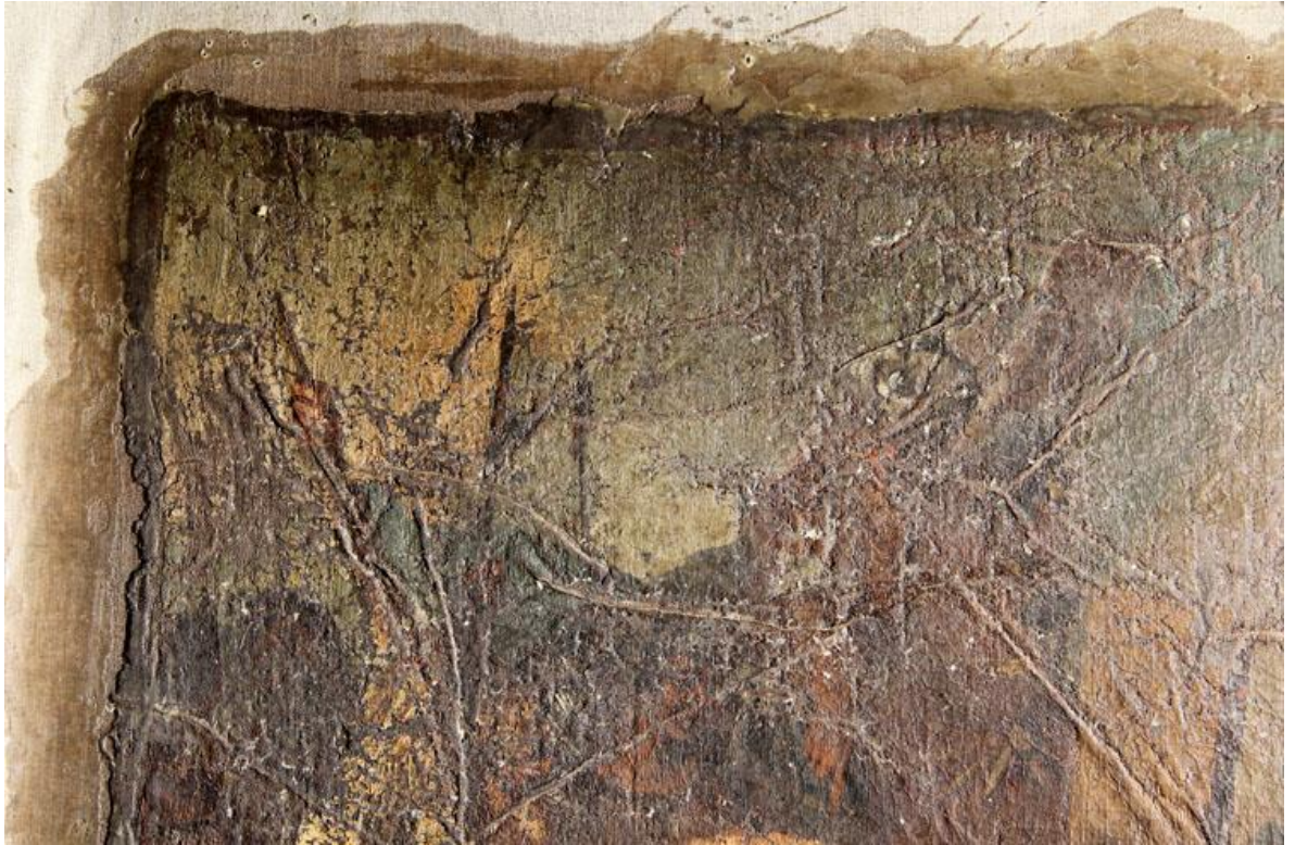
Rozsáhlé mechanické poškození - textilní podložka společně s malbou (barevnou vrstvou i podkladem) poškozena různě velkými sklady podložky. Ke zvýraznění defektů došlo v razantním bočním osvětlení.
