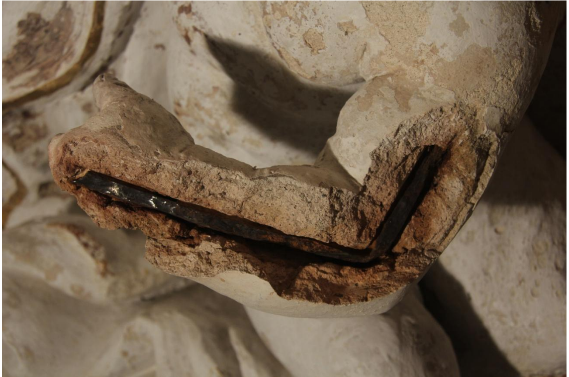
Obr. 170 Kaple sv. Pavla, bazilika Nanebevzetí Panny Marie a sv. Cyrila a Metoděje ve Velehradě, původní vnitřní armatura v ruce andílka (poškození vlivem koroze).
