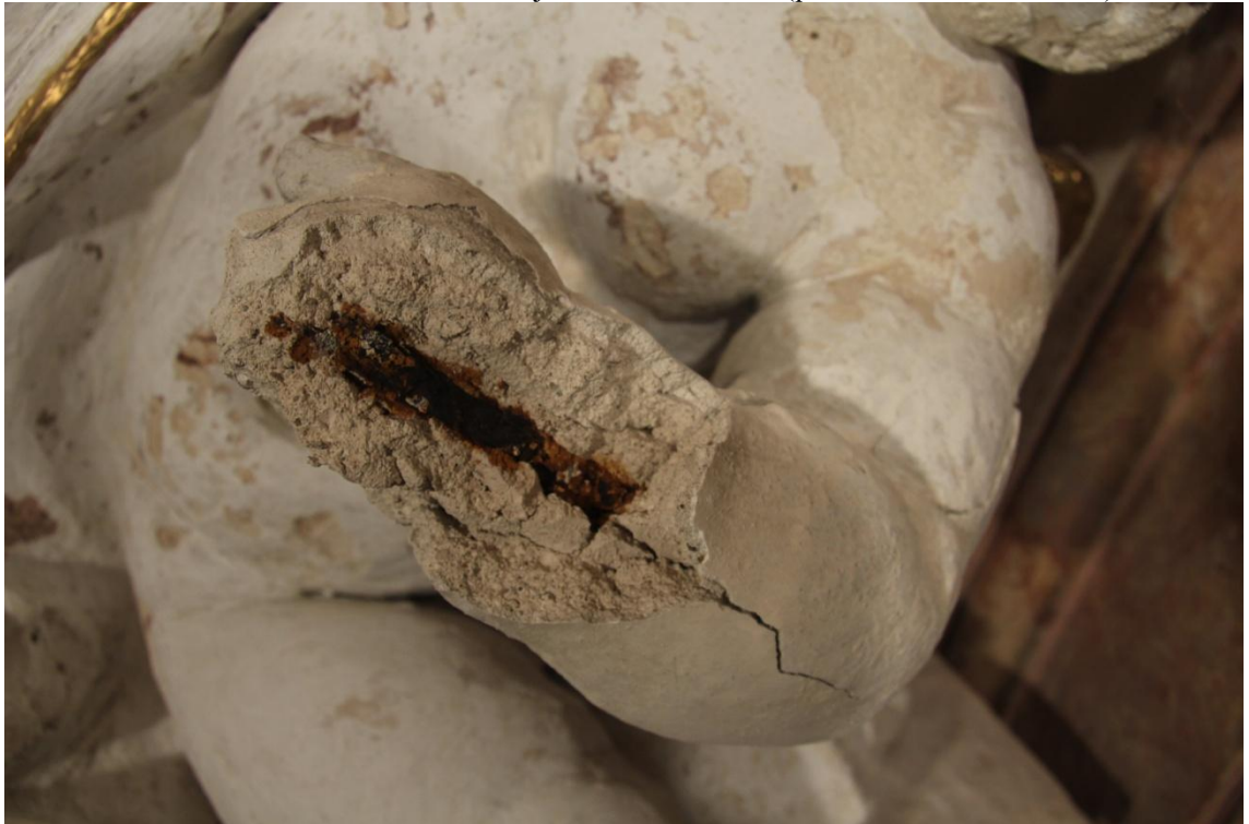
Obr. 169 Kaple sv. Pavla, bazilika Nanebevzetí Panny Marie a sv. Cyrila a Metoděje ve Velehradě, Původní vnitřní armatura v ruce andílka. (poškození vlivem koroze).
