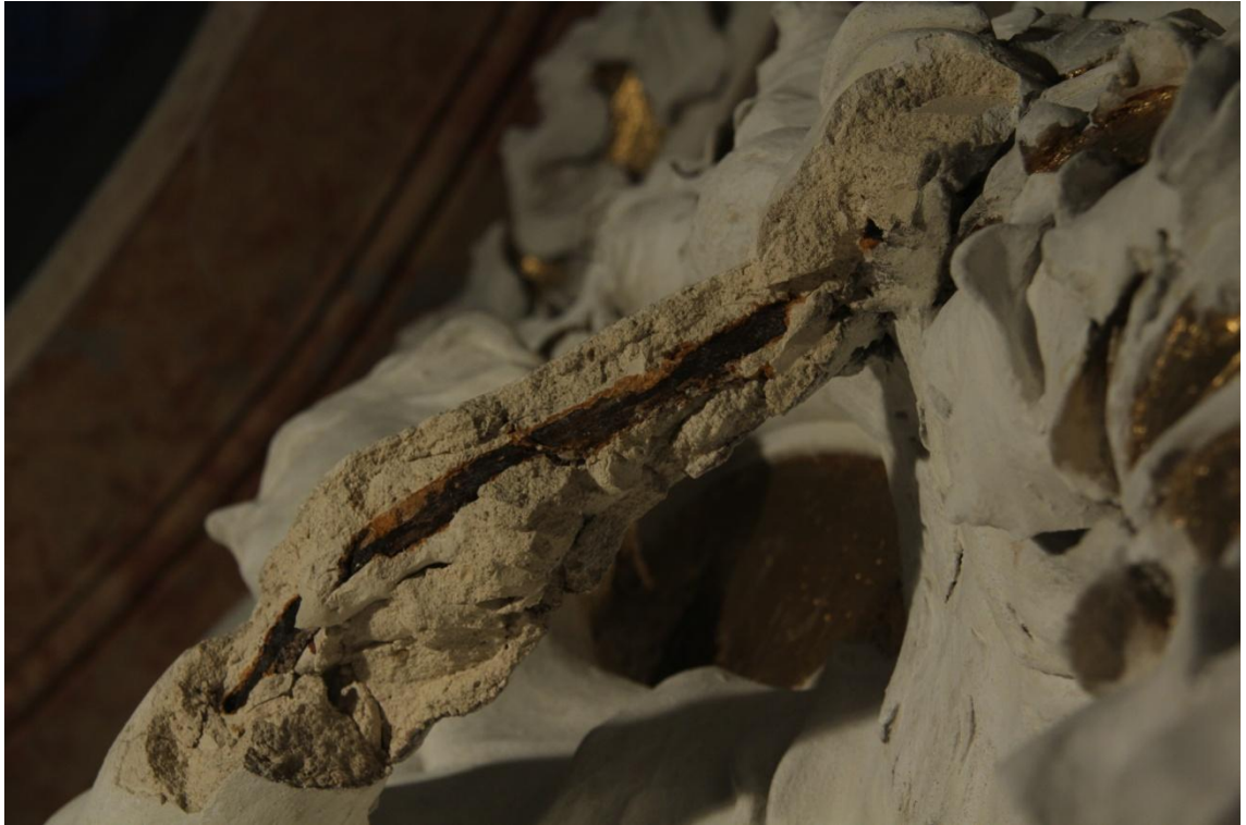
Obr. 168 Kaple sv. Hedviky, bazilika Nanebevzetí Panny Marie a sv. Cyrila a Metoděje ve Velehradě, vnitřní kovová armatura ruky Cheruba, patrně nahození drátu sádrovou maltou v malé tloušťce, následně modelováno jádro v hrubé maltě (poškození vlivem koroze).
