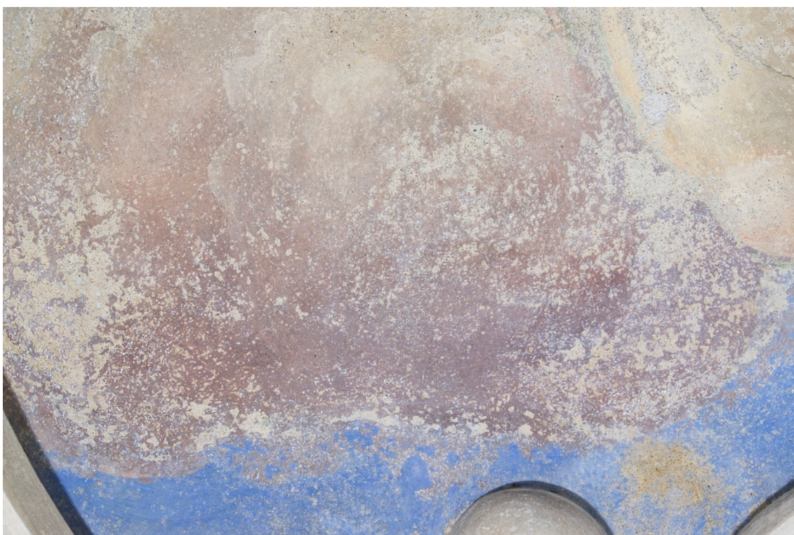
Obr. 18: Poškození: ztráta barevné vrstvy. Levý mrak. Stav po odkryvu a čištění
