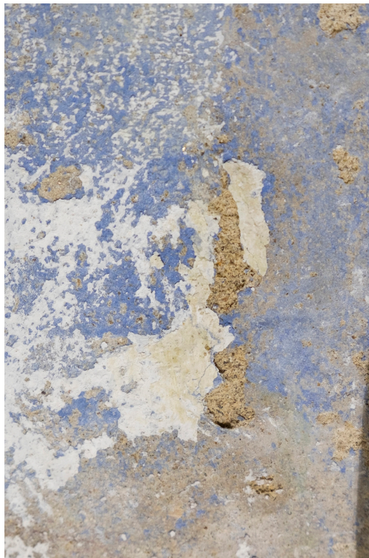
Obr.22: Detail poškození: ztráta koheze omítky a adheze původní barevné vrstvy. Oblouha v pravé části výjevu. Stav v průběhu odkryvu.
