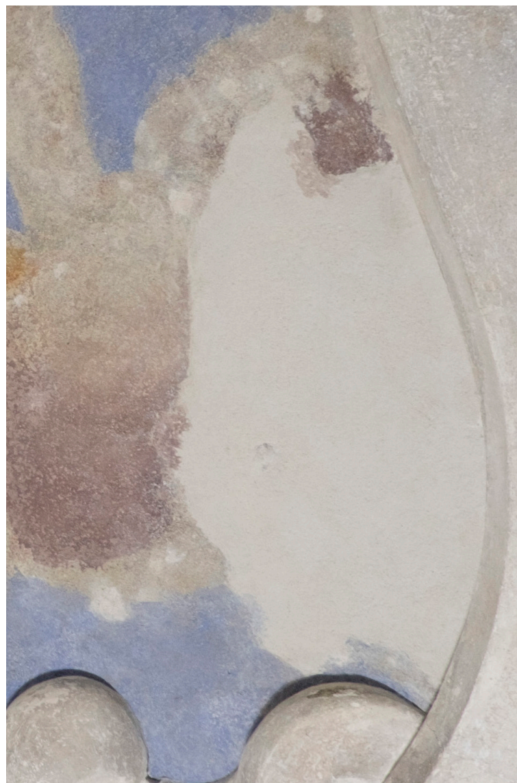
Obr. 61: Sekvence: defekt v pravém mraku po nanesení vápenného pačoku.
