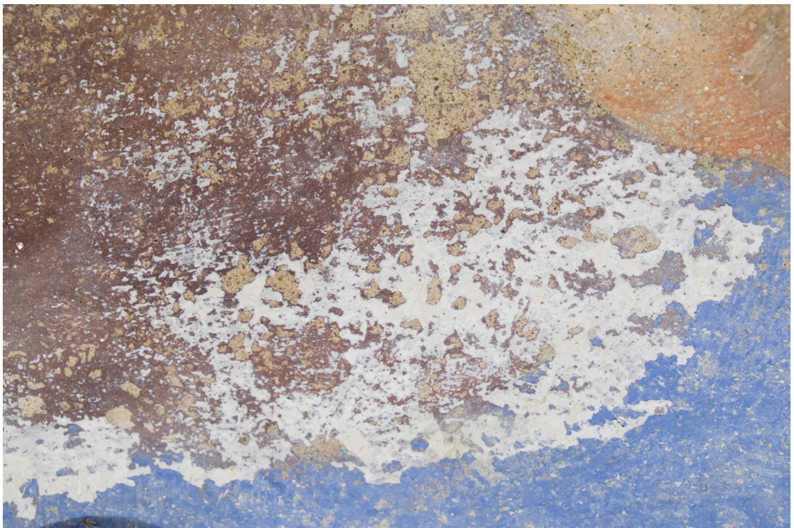
Obr. 14: Druhotné zásahy: souvrství vápenných nátěrů se silnou adhezí k původní barevné vrstvě. Mrak v levé části výjevu. Stav v průběhu čištění.
