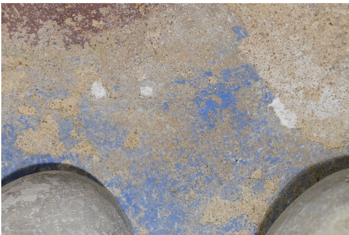
Obr. 20: Detail poškození: ztráta koheze a následně i adheze spodní omítkové vrstvy. Oblouha v pravé dolní části výjevu. Stav po očištění, prekonsolidaci a strukturální konsolidaci omítkových vrstev.
