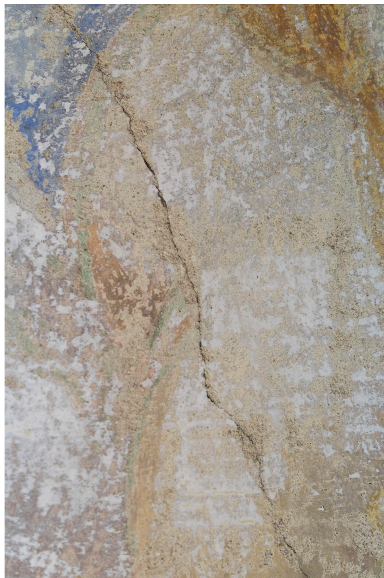
Obr. 16: Detail poškození: prasklina v těle postavy v místě sondy z roku 2011. Stav před restaurováním.
