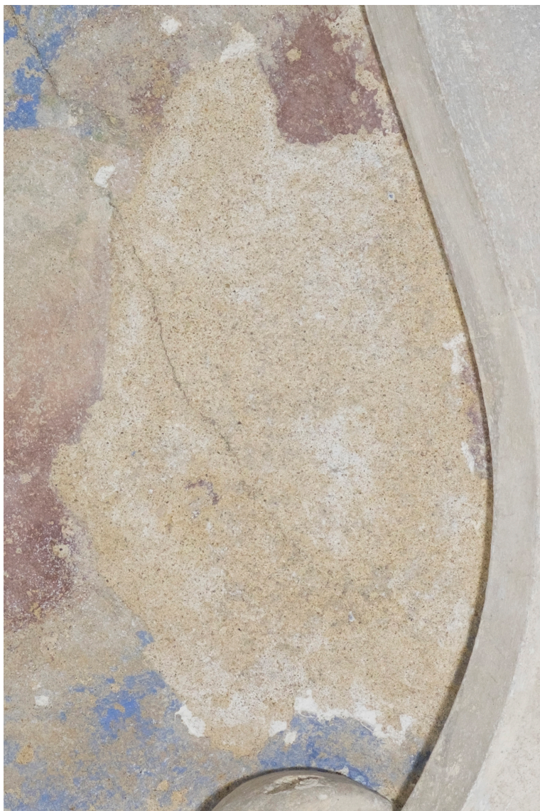
Obr.21: Poškození: defekt s úplnou ztrátou barevné vrstvy. Pravý mrak. Stav po očištění, prekonsolidaci a strukturální konsolidaci původní omítkové vrstvy.
