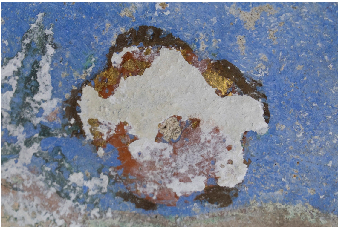
Obr. 17: Detail poškození: odlupující se vrstva plátkového zlata. Květina v levé horní části výjevu. Stav v průběhu odkryvu.
