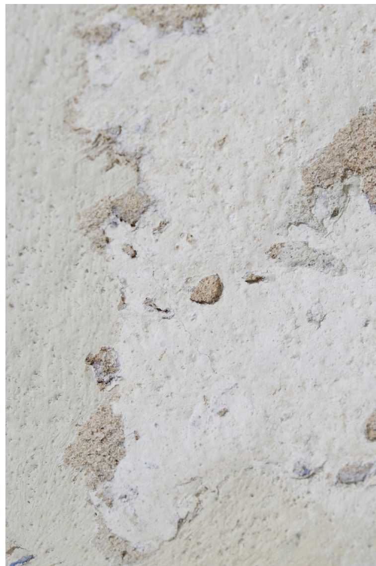
Obr. 12: Druhotné zásahy: detail povrchové struktury a stavu druhotné vysprávky v místě defektu mraku. Stav v průběhu odkryvu.
