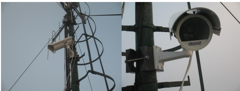
Obrázek 49 - Umístění kamery Basler pro měření dohlednosti na věži meteorologické observatoře na Milešovce
