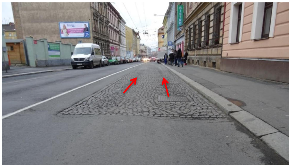
Obr. 12 Vyjeté koleje přes zastávku „Tylova“
