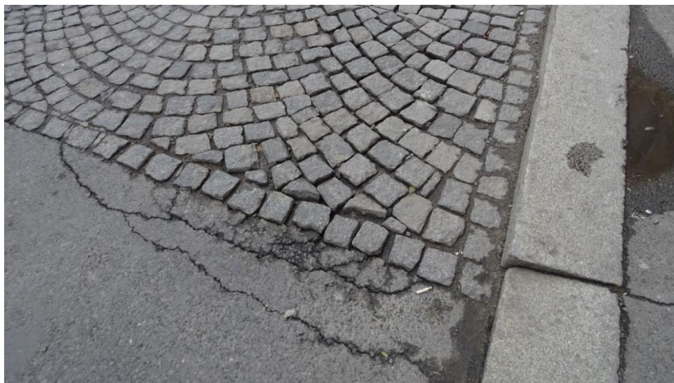
Obr. 11 Lámající se asfalt okolo zastávky „Tylova“
