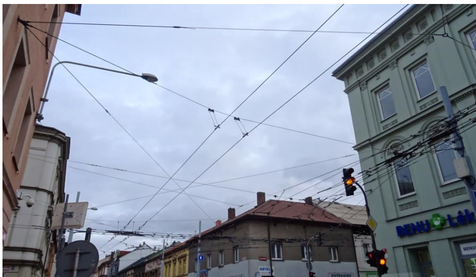
Obr. 9 Prosté trolejové vedení na převěsných laněch
