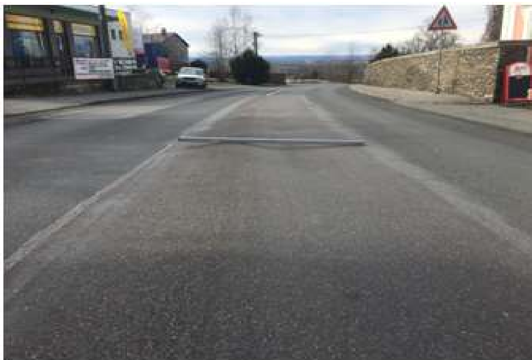
Obrázek 19: Nedostačující vodorovné dopravní značení a absence přechodu pro chodce.
