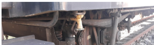
Obr. 5 Plnicí roura motorového vozu Ce 3-3413 u typu gravitačních WC
