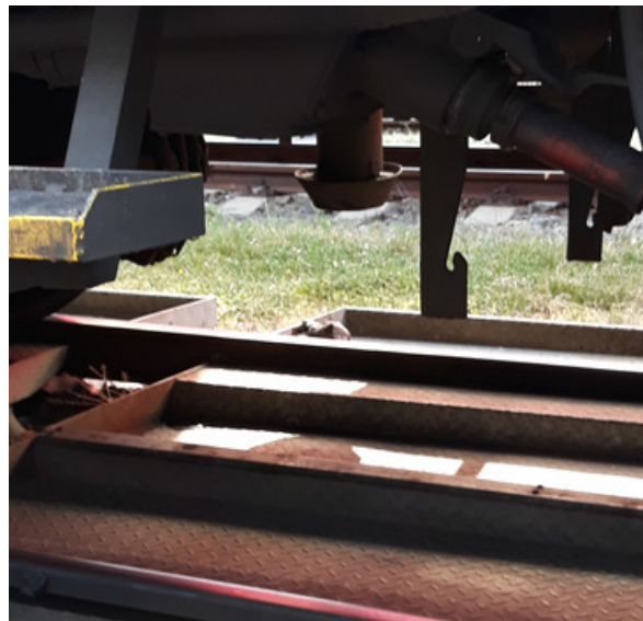
Obr. 23 Záchytná vana umístěna pod odpadní rourou gravitačního WC
