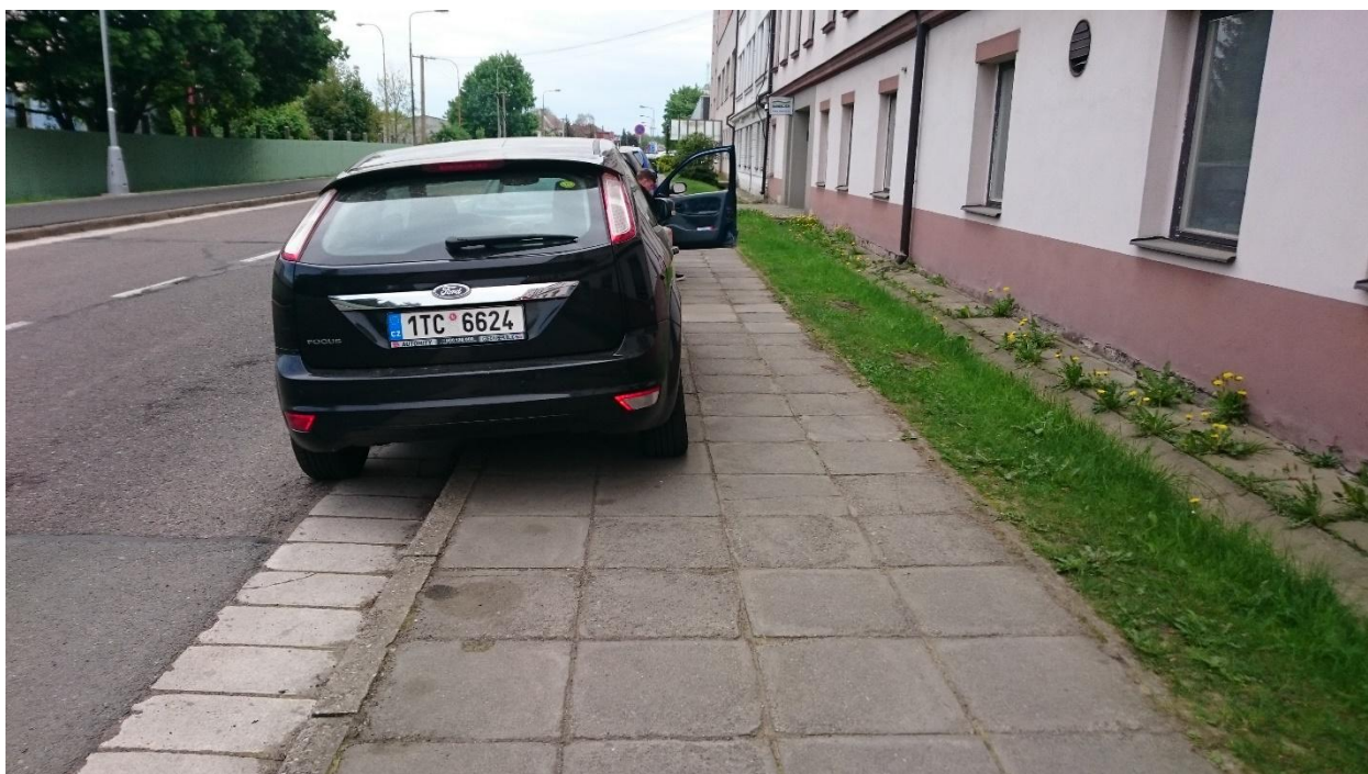
Foto č. 8 – Stávající stav – Nevyhovující šířkové parametry chodníku pro průchod pěších i s nebezpečným jevem při otevření dveří od vozidla. Navrhovaný stav – Obousměrný chodník pro pěší s dostatečnou šířkou.
