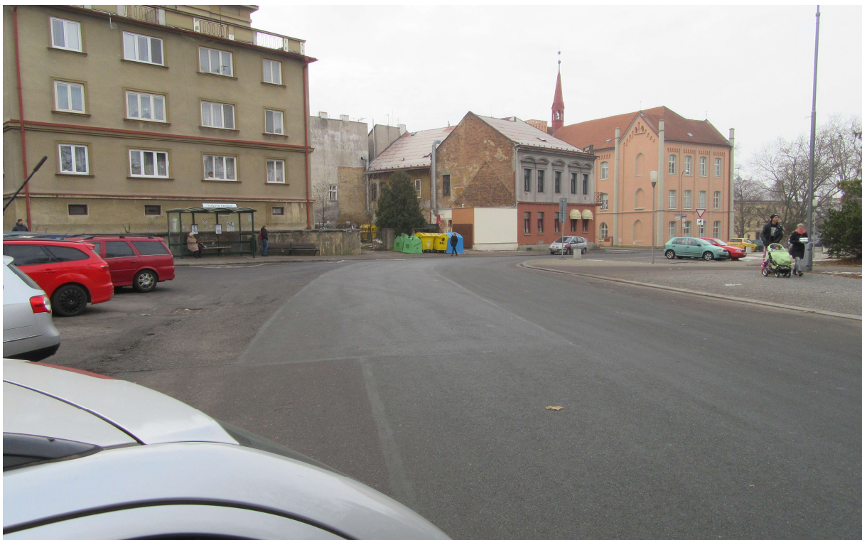
Obrázek 21: Pohled na Školní náměstí v protisměru staničení. Chybí vodorovné dopravní značení komunikace. Vlevo je vidět neuspořádané parkování vozidel, které brání v rozhledu na křižovatkách Tyršova a Školního náměstí.
