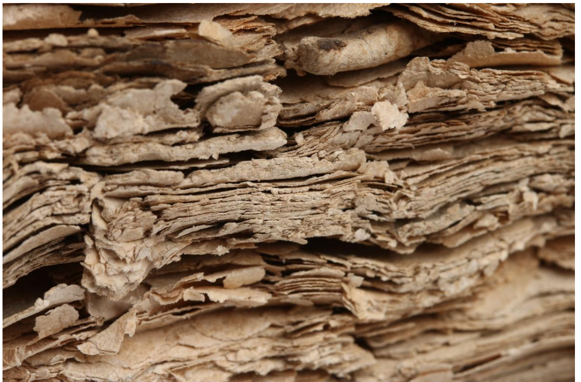
Obr. – 43 poškodenie oriezky
