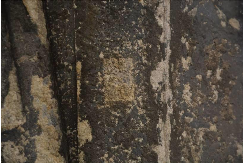
Obr. 48 Reliéf sv. Jakuba – Zkouška čištění – narušený povrch
