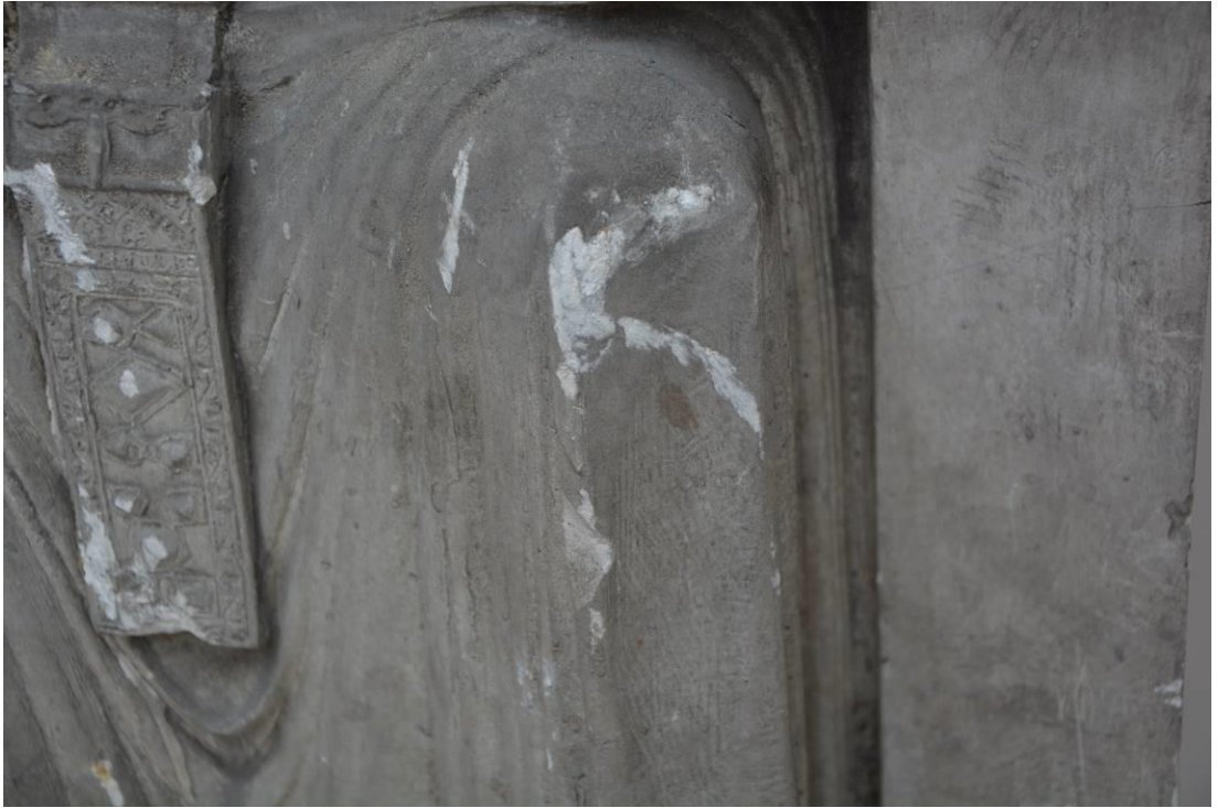
Obr. 94 Socha alegorie umění – mechanické poškození
