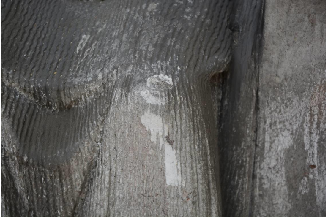
Obr. 85 Socha alegorie průmyslu – mechanické poškození
