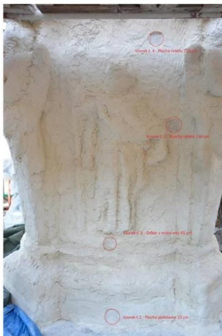
Obr. 20 Lokalizace míst odběru vzorků odsolovacích zábalů Vzorky č. 1-4. Reliéf sv. Jakuba Většího.
