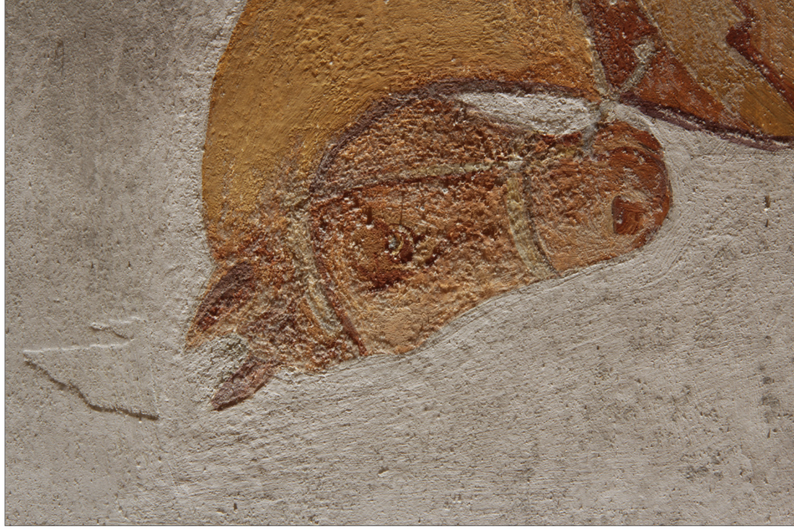
Obr. 08 Snímek malby v ostrém bočním nasvícení. Na fotografii je patrná ztráta spodní barevné vrstvy nad hlavou koně. Na hlavě se nachází biologické napadení. Křk pokrývá vrstva přemalby s odlišným barevným odstínem.
