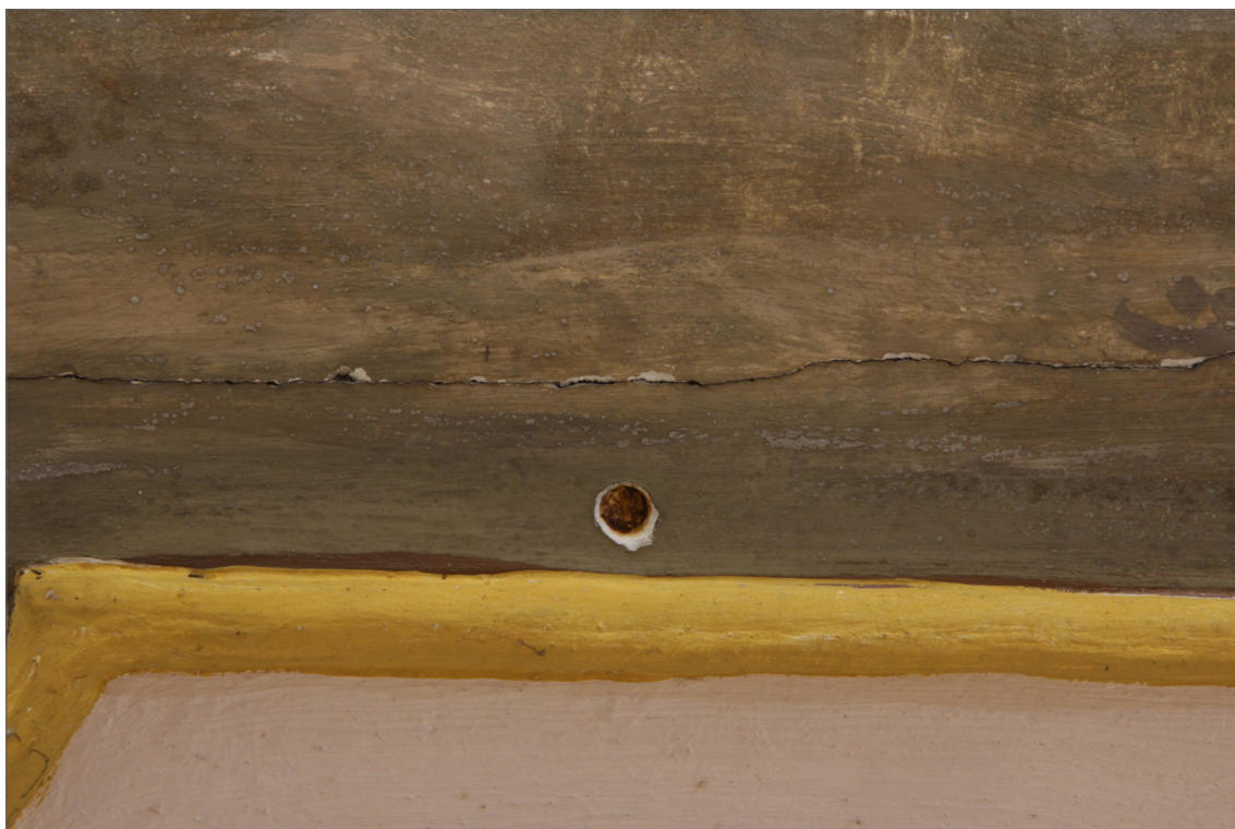
Obr. 12 Na spodním okraji výjevu se nacházel otvor po vrutu, kterým byl připevněn sádrový panel k dřevěnému podbití.
