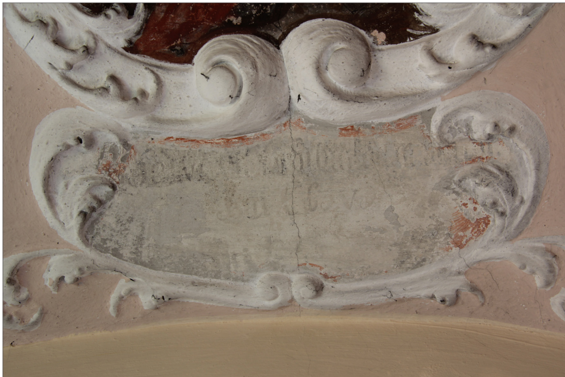
Obr. 63 Textové pole - stav před provedením restaurátorského zásahu.
