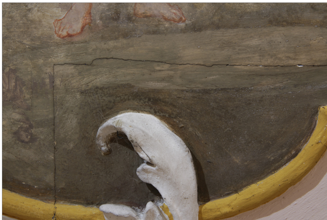
Obr. 11 Na výjevu se nacházely pravidelné trhliny způsobené pohybem podkladových sádrových panelů. Na fotografii je také viditelný pás kde tyto trhliny byly přetřeny tmelem.
