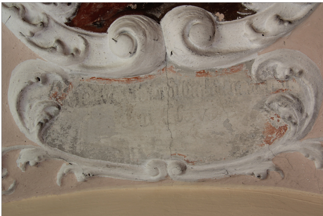
Obr. 55 Stav textového pole před započítím restaurátorských prací.
