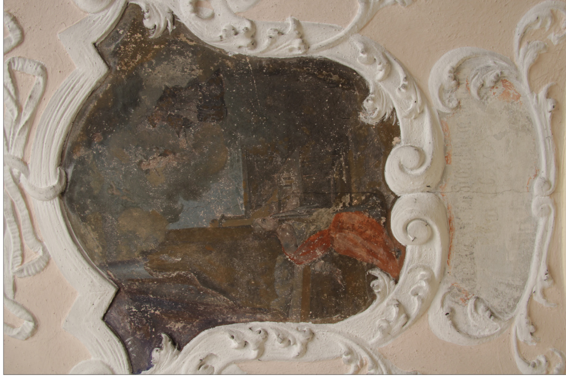
Obr. 49 Průzkum v umělém nasvětlení. Silně zatmavený povrch malby s četnými defekty barevné vrstvy. Šedo-hnědé druhotné přemalby.
