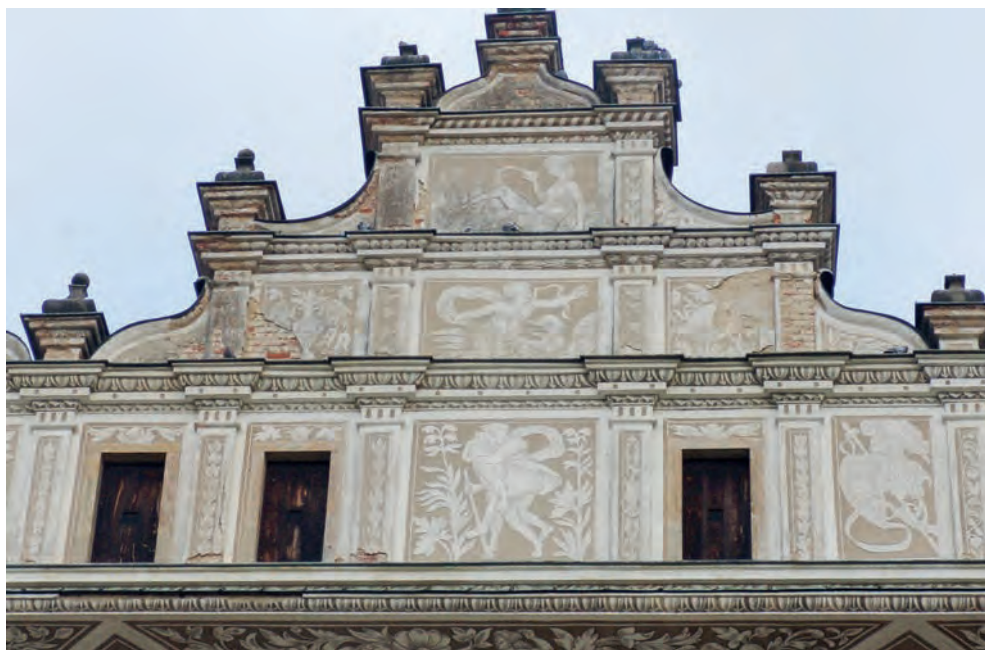
Obr. 8 (nahoře) Pohled na část atiky jihozápadní fasády. Omítky jsou výrazně destruovány, některé její části již odpadly. V pravé části snímku pozorujeme odhalení poškozené originální sgrafitové výzdoby. (Foto J. Vojtěchovský, 2011)
