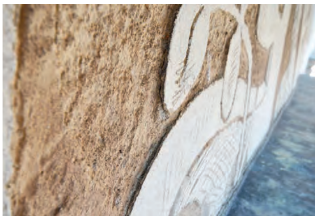
Obr. 9 (vpravo) Detail nejzápadnější lunety horního sgrafitového pásu – patrné oddělování intonaca bianca i se vrchní vrstvou intonaca colorata. (Foto M. Vedral, 2012)
