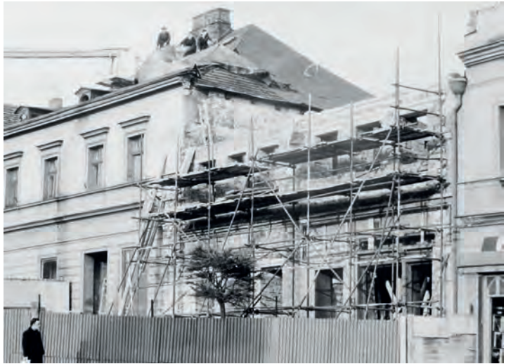
Obr. 11 Havlíčkův Brod, radikální, nezdařená a zřejmě nelegální rekonstrukce domů č. p. 161 a 162. (Foto SOKA, fond „Sbírka fotografií“, kart. 4, č. 51)
