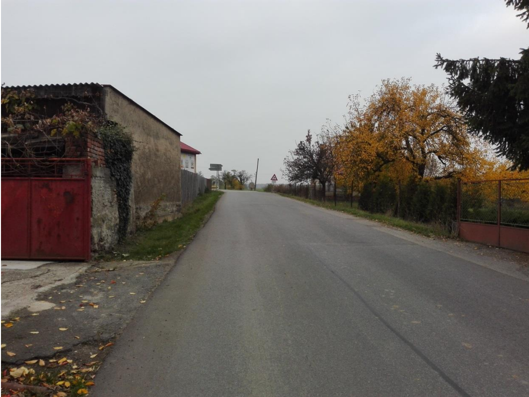
Foto 19 – Severozápadní pohled na silnici III/27612 vedoucí k obci Husí Lhota
