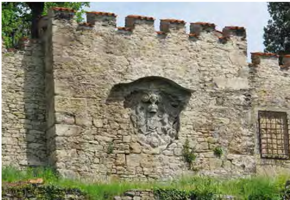
34) Znak Kutné Hory umístěný ve zdi terasy pod Vlašským dvorem. Umístění plechové stříšky omezí omývání povrchu srážkovou vodou.
