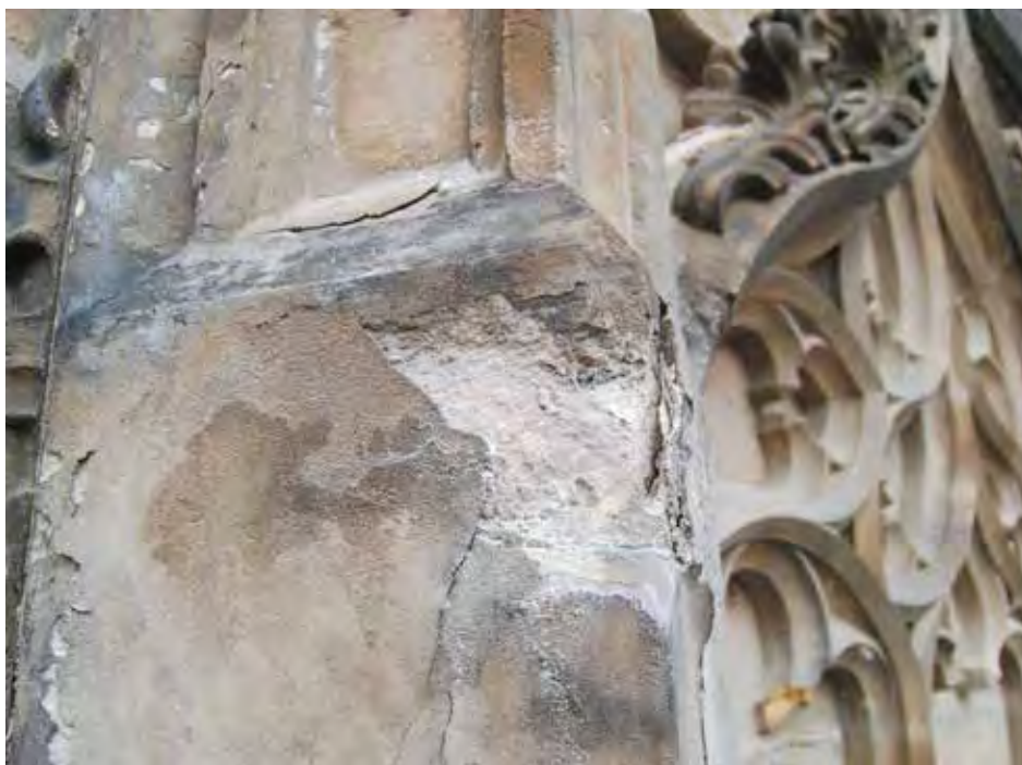
32) Kamenná kašna - detail poškození kamene pod cementovým přetěrem.
