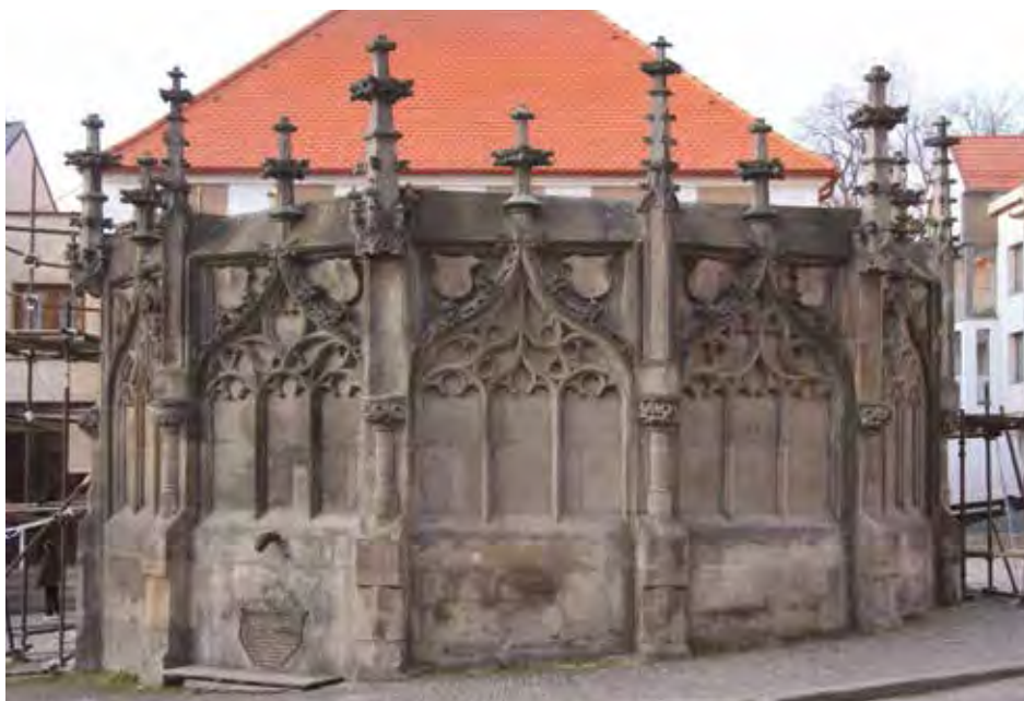
28) Kamenná kašna - stav před restaurováním v roce 2009.
