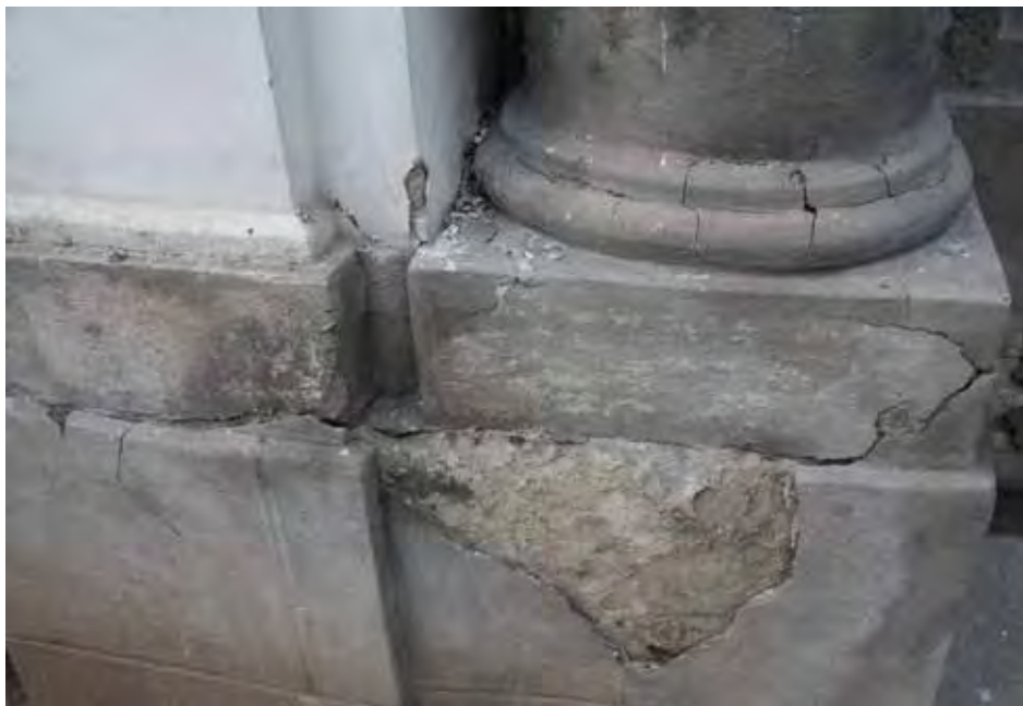
26) Kostel sv. Jana Nepomuckého. Plošné překrytí kamene tvrdým cementovým tmelem v partiích dotovaných vzlínající vlhkostí vedlo k úplnému rozpadu kamene pod vysprávkami.
