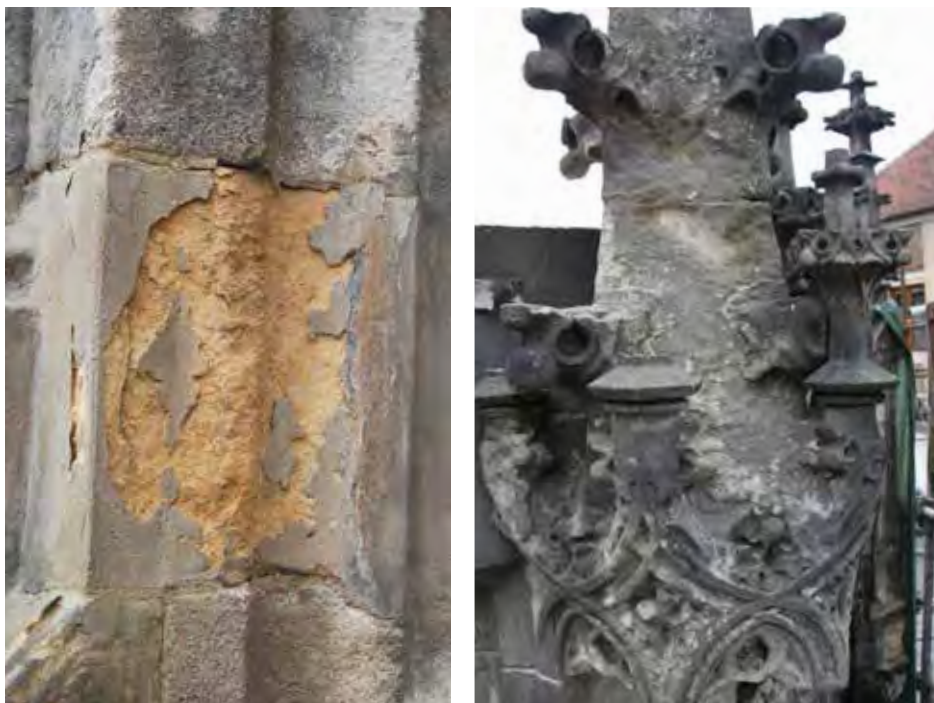
29) Kamenná kašna - detail poškození kamene pod cementovými vysprávkami.
