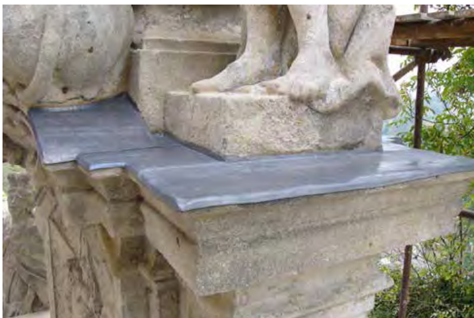
35) Socha sv. Václava před jezuitskou kolejí. Oplechování římsy podstavce olověným plechem výrazně omezilo zatékání do kamene.
