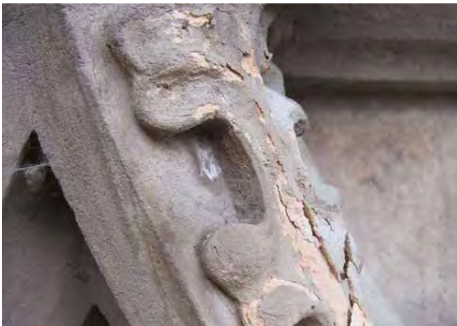
31) Kamenná kašna - detail poškození kamene pod cementovým přetěrem.
