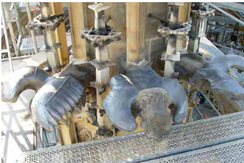
36) Chrám sv. Barbory. Andělé na centrálním pilíři presbyteria byli vážně narušeni zatékáním, proto bylo přistoupeno ke zhotovení oplechování horní plochy z tenkého olověného plechu. Jde spíše o kuriózní případ užití olověného plechu, ale v tomto případě zřejmě napomůže omezit zatékání. Přitom z podhledu plech není nijak patrný.
