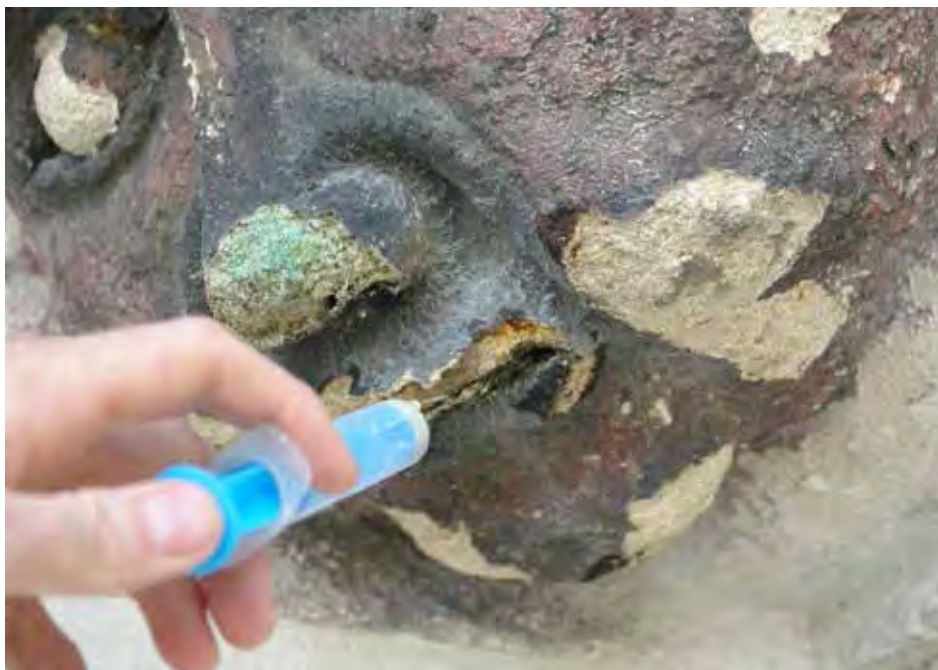
8) Maskaron ze severní stěny chrámu - zpevňování kamene pod krustou.
