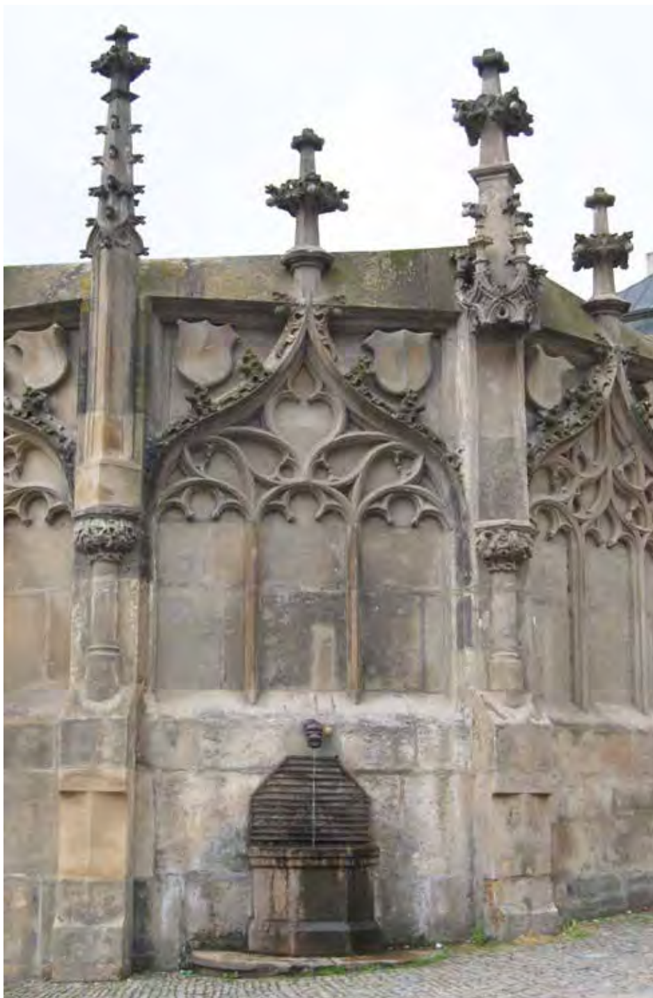
27) Kamenná kašna - stav před restaurováním v roce 2009.
