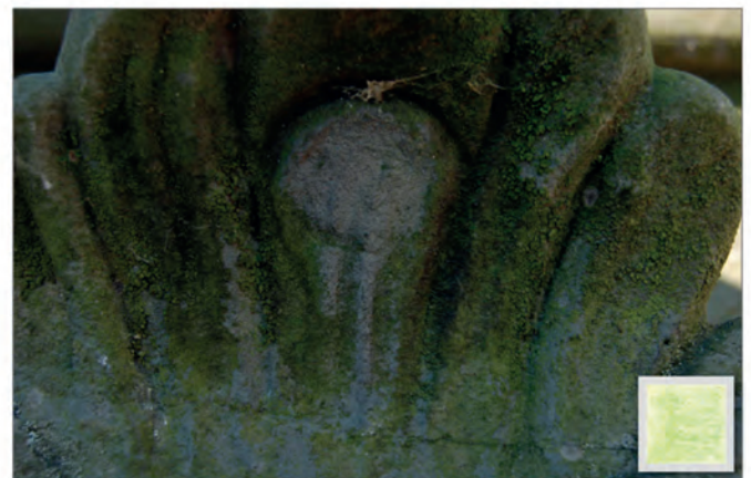
legenda grafického vyhodnocení stavu – snímek ilustrující povlaky biologického původu
