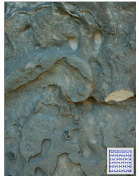
legenda grafického vyhodnocení stavu – snímek ilustrující hloubkovou korozní ztrátu originální hmoty
