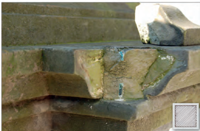
legenda grafického vyhodnocení stavu – snímek ilustrující mechanické poškození
