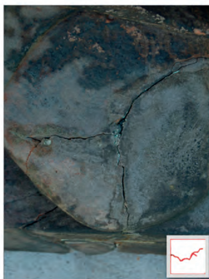
legenda grafického vyhodnocení stavu – snímek ilustrující praskliny
