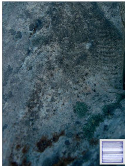
legenda grafického vyhodnocení stavu – snímek ilustrující povrchovou korozní ztrátu originální hmoty
