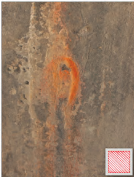
legenda grafického vyhodnocení stavu – snímek ilustrující anomálie v bloku kamene
