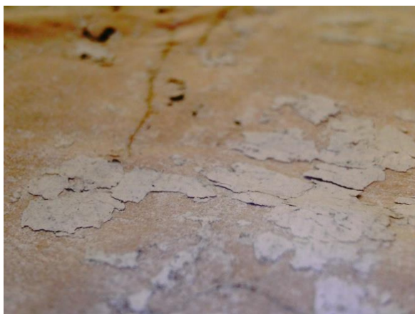
Obr. 133 Poškozená křídová vrstva, sig. 67.601
