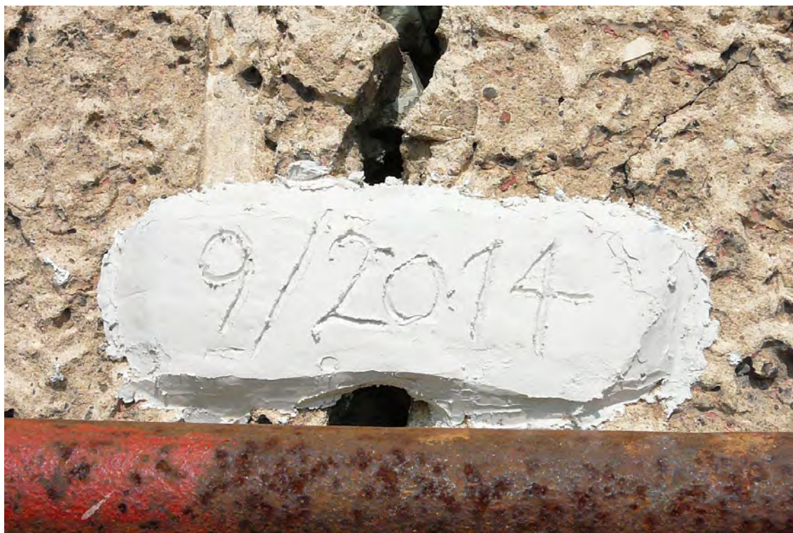
Obr. 78: Zkouška aktivity statických trhlin pomocí sádrového pásku s vyznačeným datem aplikace (zdroj: http://www.prozahorany.cz )
