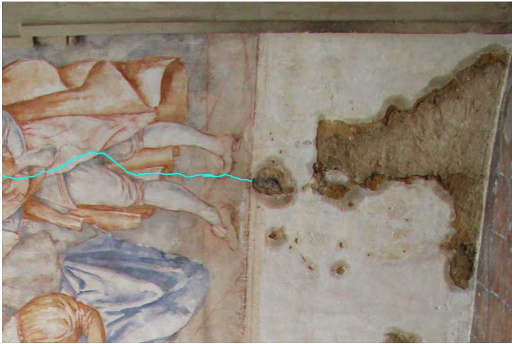
Obr. 71: Průběh statické trhliny s dosahem do soklové části; problém byl pravděpodobně řešen již v minulosti - na místě defektu se nacházela rozsáhlá vyspráva; Humprecht - akustický sál
