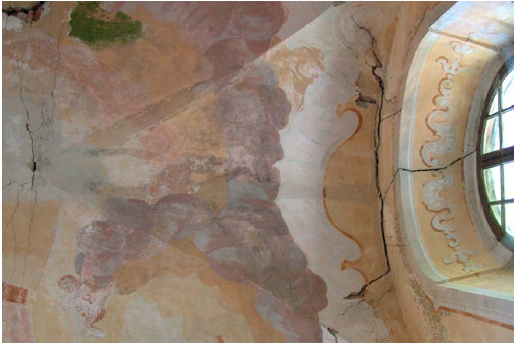
Obr. 70: Část místo statické trhliny v místě dosesnutí klenby na nosné zdivo, zvláště oslabené místo okenní špalety; kaple sv. Kříže ve Slavonicích ( zdroj: KRHÁNKOVÁ, K. a kol. 2014 )
