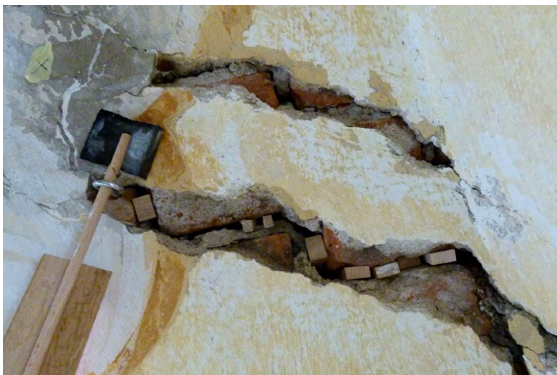
Obr. 73: Statická trhlina kopírující diagonálně spáru mezi cihlami; kaple sv. Kříže ve Slavonicích (zdroj: KRHÁNKOVÁ, K. a kol. 2014)
