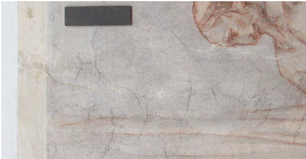
Obr. 56: Statická trhlina v horní části; stav po injektáži a vytmelení
