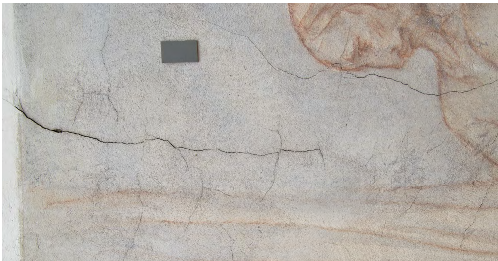
Obr. 55: Statická trhlina v horní části; stav před restaurováním
