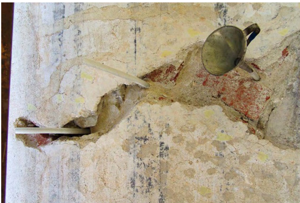
Obr. 86: Injektaž hloubkových spár ve zdivu pomocí zavedených hadiček; zámek Kratochvíle (zdroj: WAISSE-ROVÁ, J. a kol. 2005 )
