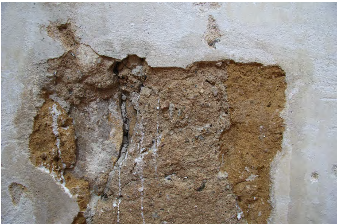
Obr. 39: Oblast rozsáhlého tmele pod statickou trhlinou; pod tmelem z roku 1937 se zčásti nachází jádrová omítka z téže doby (šedočervené zbarvení uprostřed), zčásti historické jádro (okrové). V levé části odhaleno kamenné zdivo. Stav v průběhu zpevňování Ledanem TA1.
