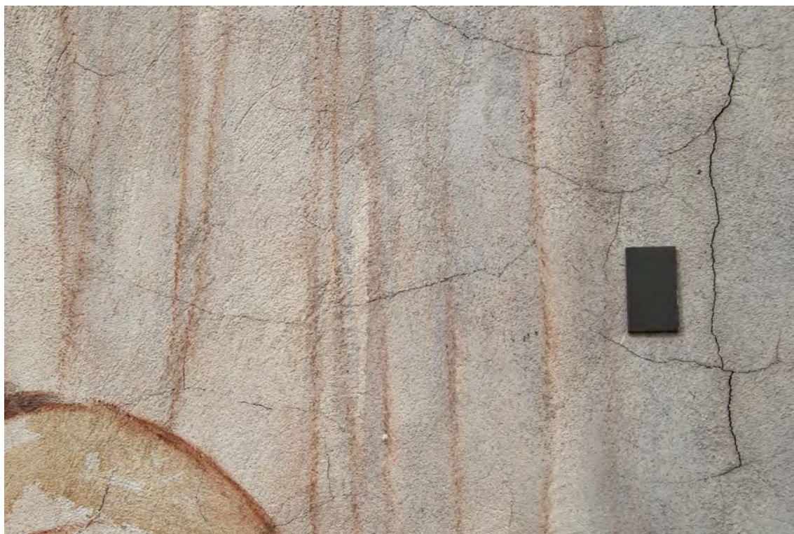
Obr. 75: Síť primárních prasklin na nástěnné malbě v akustickém sále zámku Humprecht (vpravo statická trhlina)
