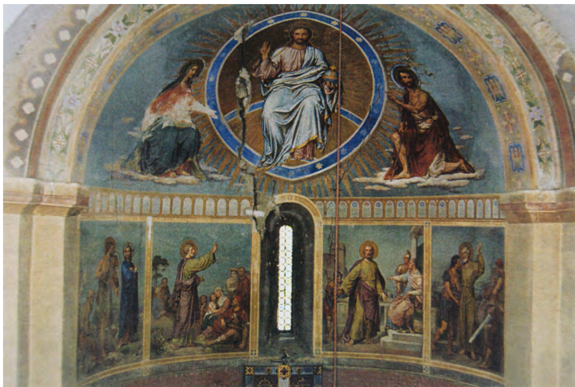
Obr. 72: Ukázka rozsáhlých statických trhlin v konše apsidy; kostel sv. Jakuba v Jakubu u Kutné Hory (zdroj: KNOROVÁ, K.; KNOR, J. 1997)
