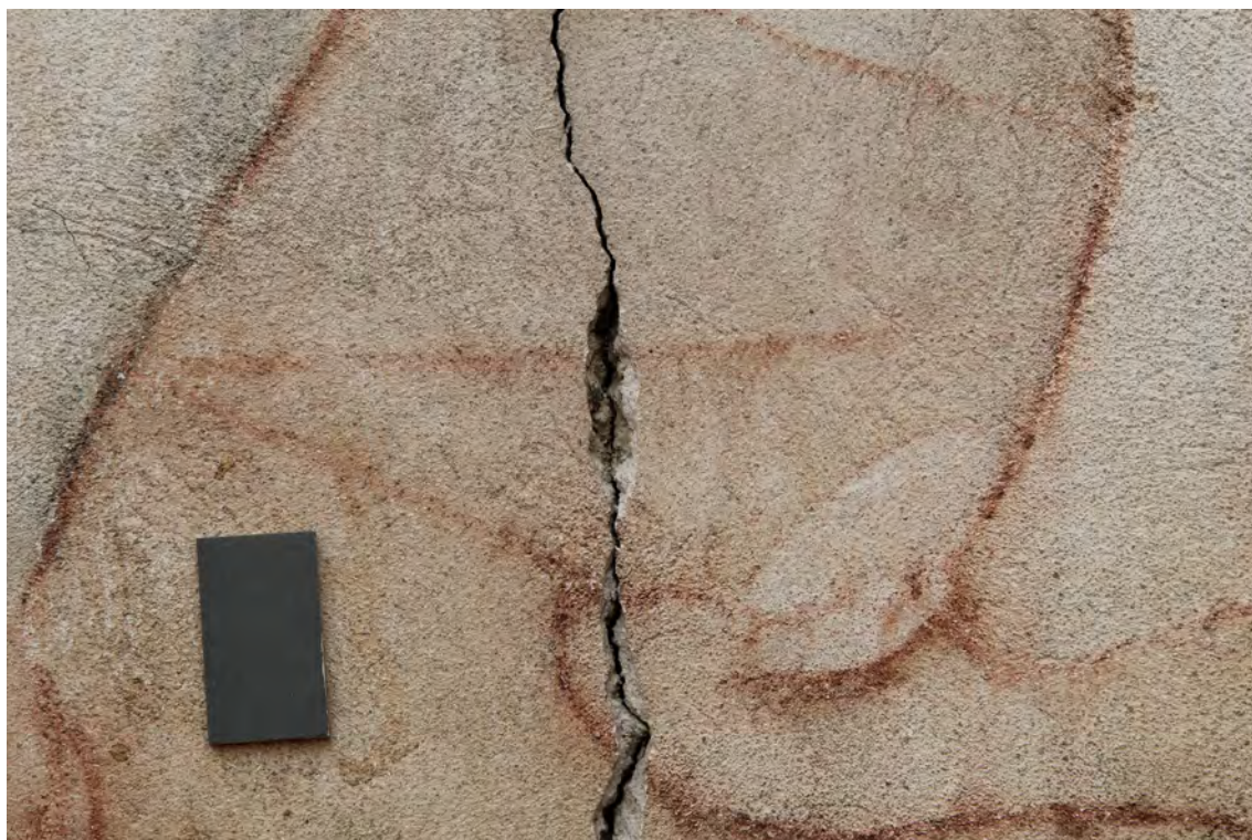
Obr. 58: Detail nejširšího místa statické trhliny; stav před restaurováním
