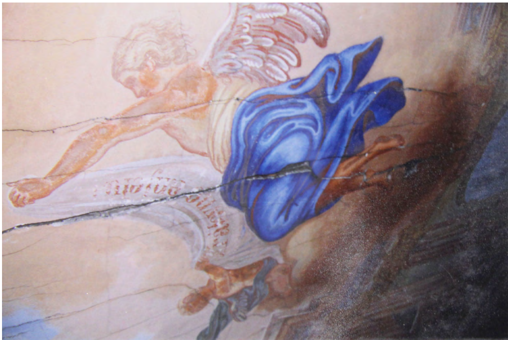
Obr. 76: Praskliny v omítce rákosového stropu kopírující průběh dřevěných fošen; kostel Navštívení Panny Marie v Bozkově (zdroj: IRKT. 1998)
