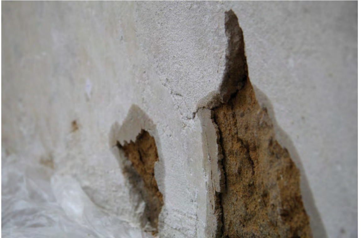
Obr. 38: Detail místa, kde byl odstraněn slabě přílnavý tmel; tenký svrchní štuk je historický, lze vidět slabou adhezi k jádru, hrubší tmel v horní části snímku pochází z roku 1937. Stav v průběhu strukturálního zpevnění omítky.
