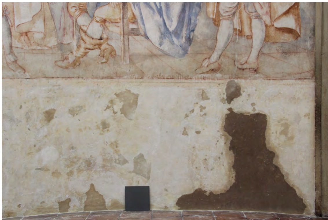
Obr. 44: Pravá část soklu, stav po odkrytí, injektáži, odstranění tmelů, strukturálním zpevnění a vytmelení
