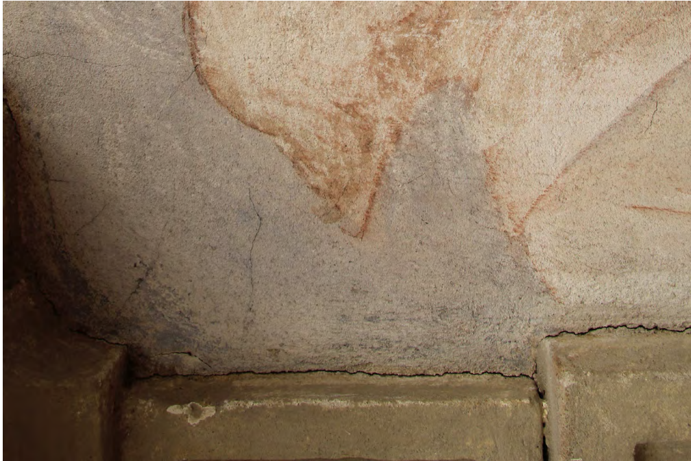
Obr. 77: Dilatační trhlina na rozhraní s kamenným dveřním ostěním; Humprecht - akustický sál
