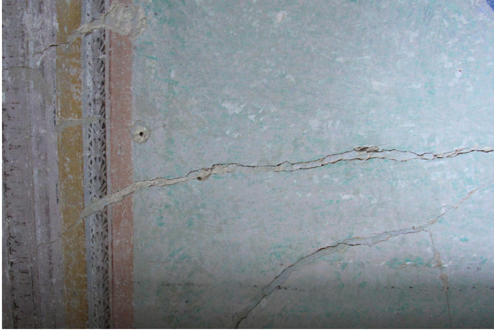
Obr. 81: Dříve již ošetřovaná statická trhlina; vysprávka přestává plnit svou funkci, což může být ukazatelem pohybu trhliny; učebna č. 1 v budově Fakulty restaurování, Jiráskova 3
