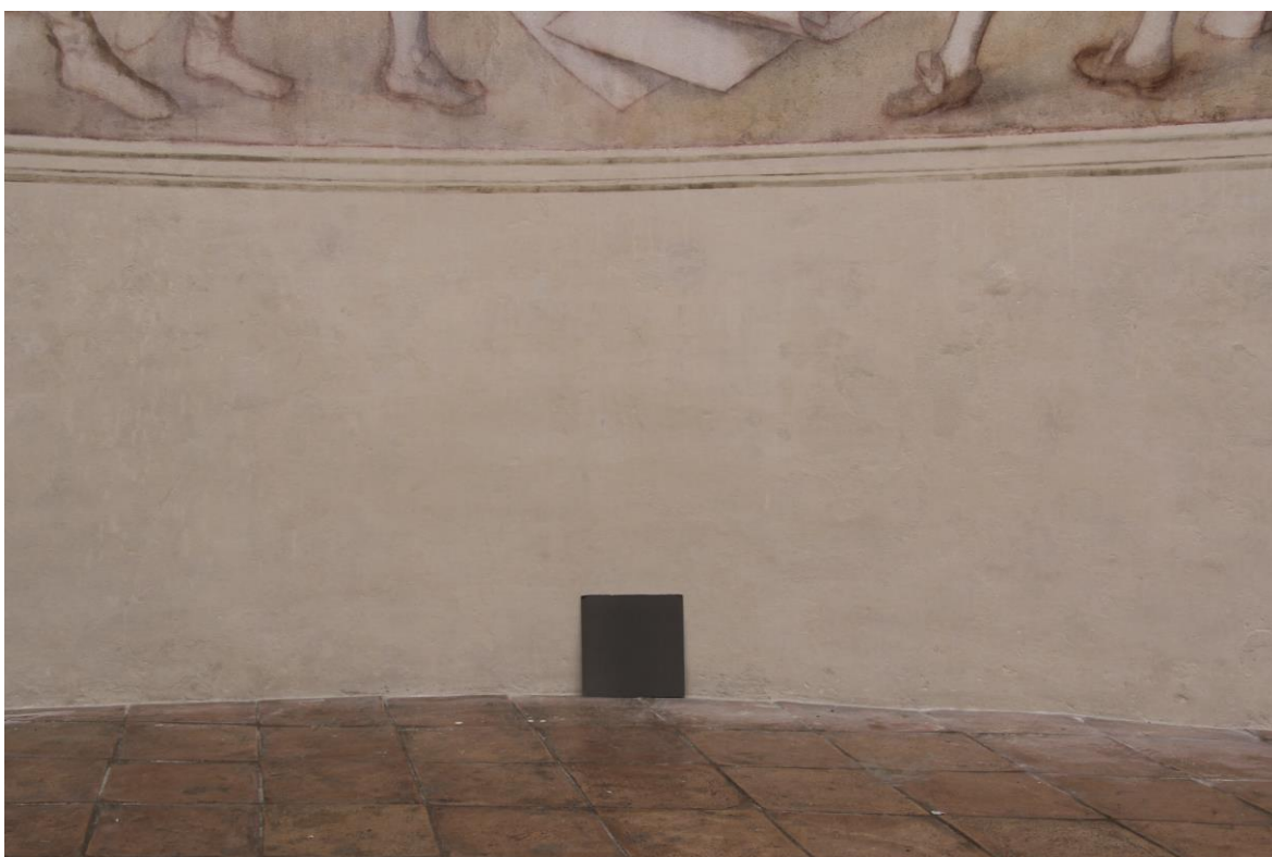
Obr. č. 79: Středová část soklové partie s historickou omítkou po scelení vápenným okrovým nátěrem a po rekonstrukci linek pod malbou.
