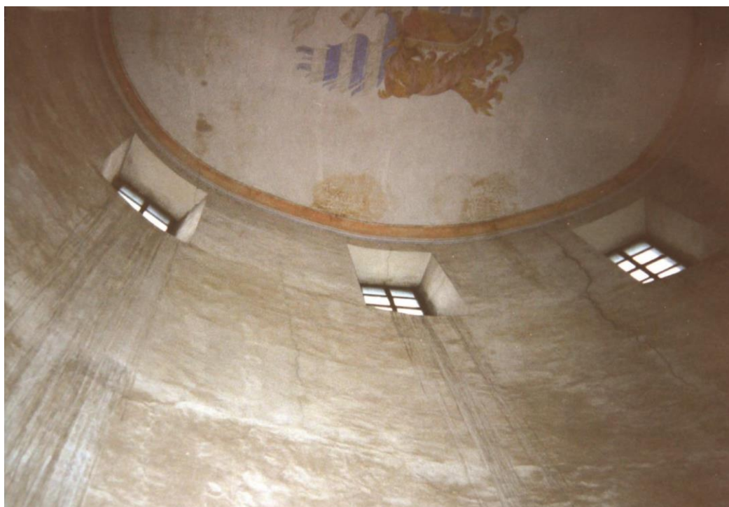
Obr. č. 29: Část stropu a jižní části stěny z doby před úpravou bílým nátěrem. Fotografie z 90. let 20. století. Na snímku je viditelná původní barevnost historické omítky. Je zde patrné poškození zatékáním srážkové vody. (Zdroj: foto Dagmar Faměrová)
