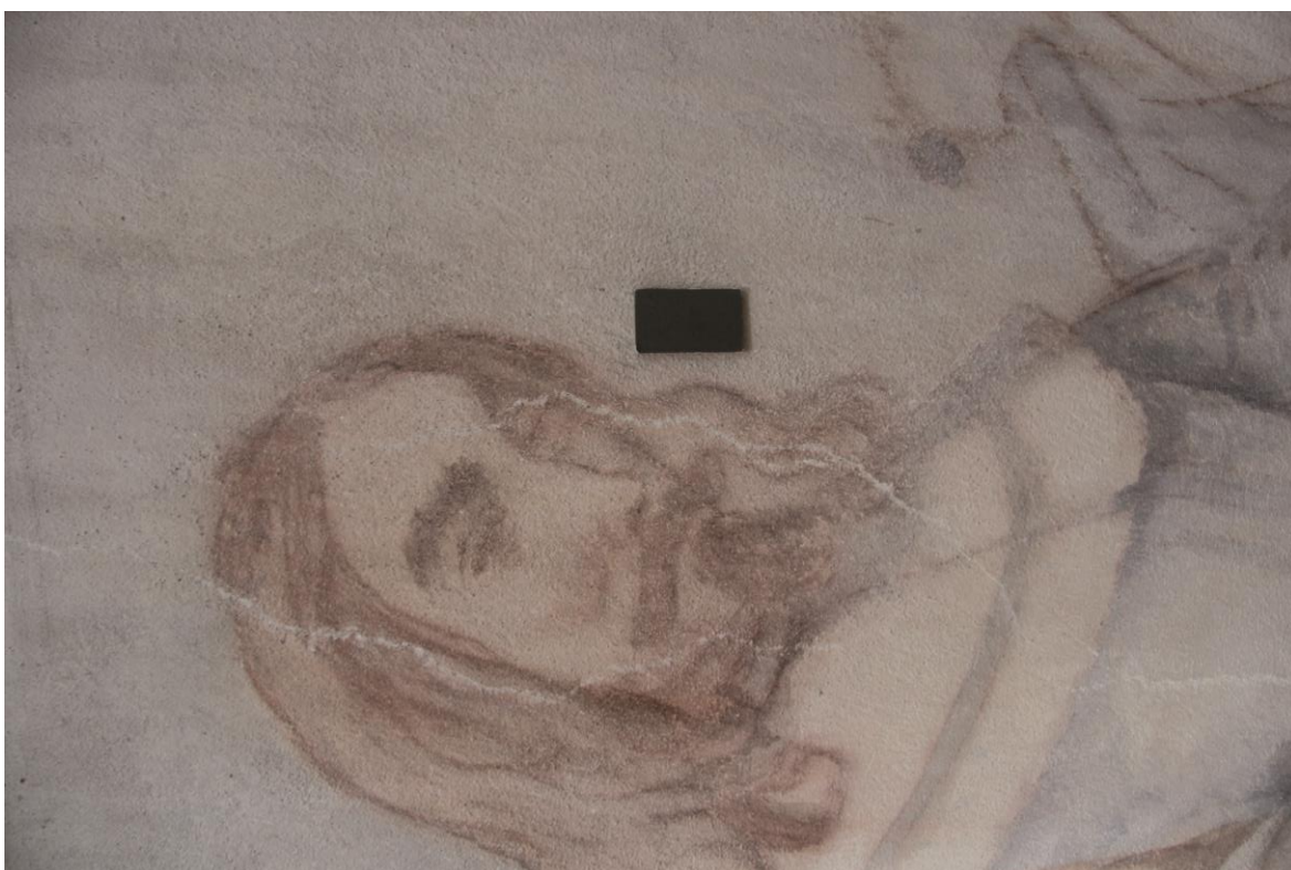
Obr. č. 53: Detail hlavy Humprechta Jana Černína, statické trhliny po injektáži a tmelení.
