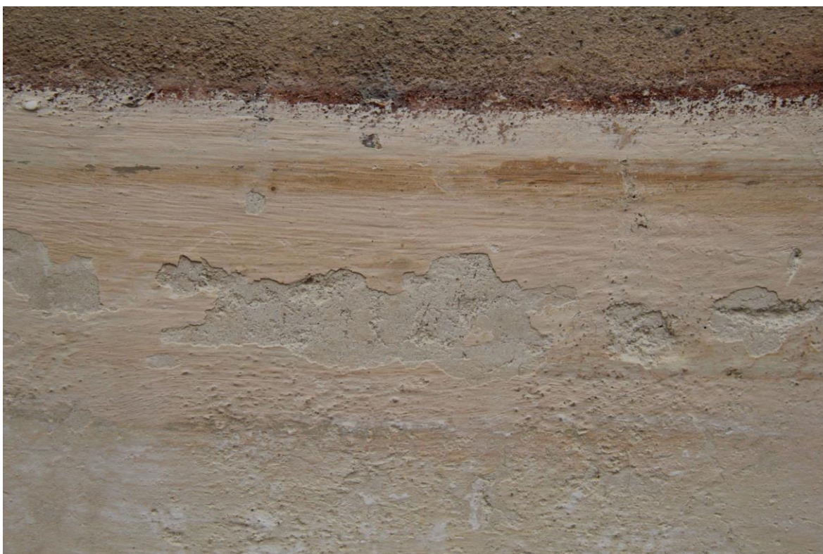
Obr. č. 40: Detail ztráty barevné vrstvy a linek pod malbou.
