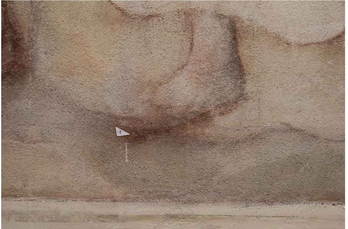
Obr. č. 74: Detail boty před restaurováním.
