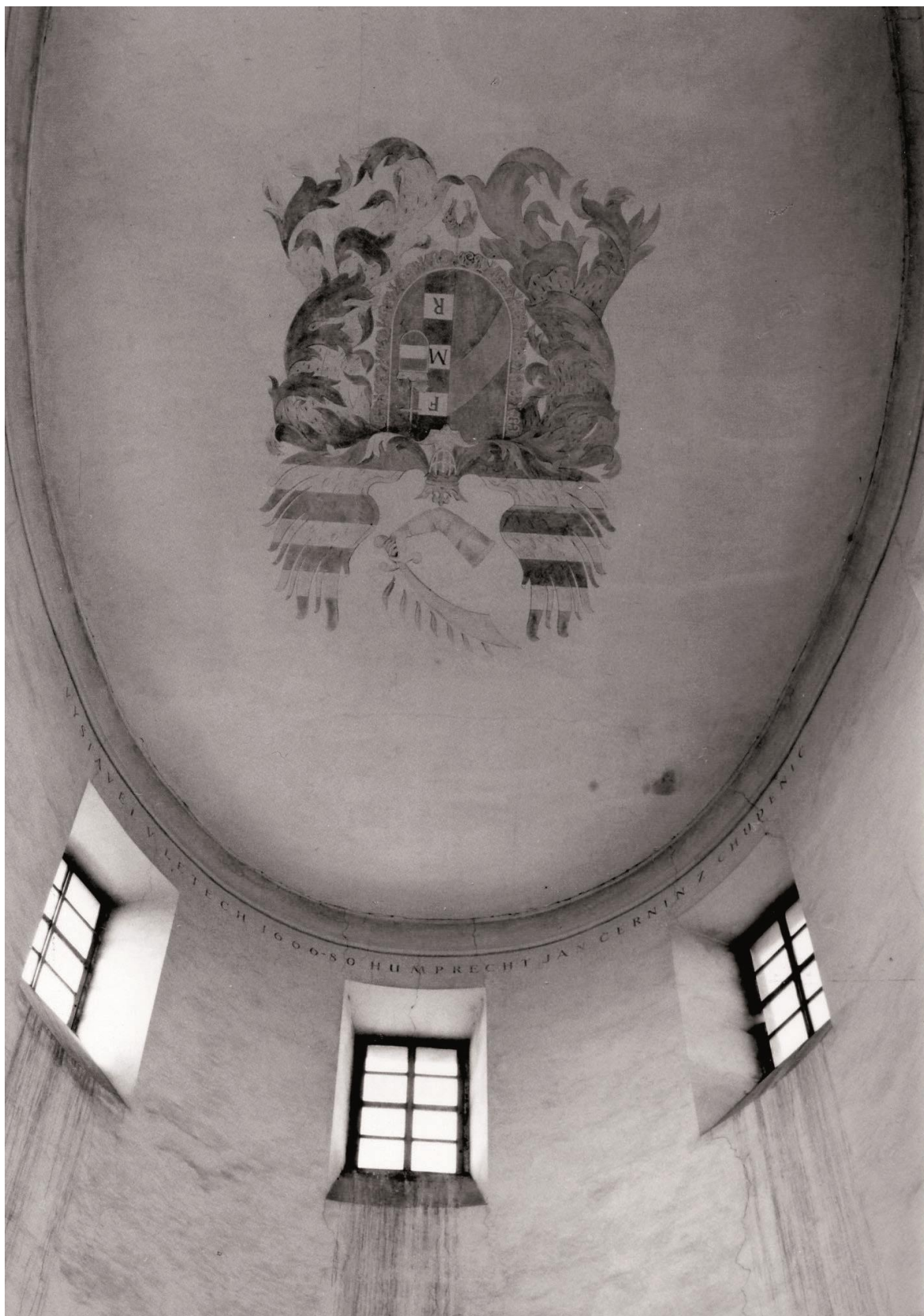
Obr. č. 27: Strop tzv. akustického hodovního sálu zámku Humprecht, fotografie z 80. let 20. století, na níž jsou patrné stékance v úrovni oken. (Zdroj: Ze sbírky Národního památkového ústavu, generálního ředitelství. Zámek Humprecht, N127768 1987 )
