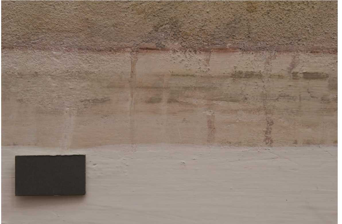
Obr. č. 41: Detail stékanců barevné vrstvy pod malbou.
