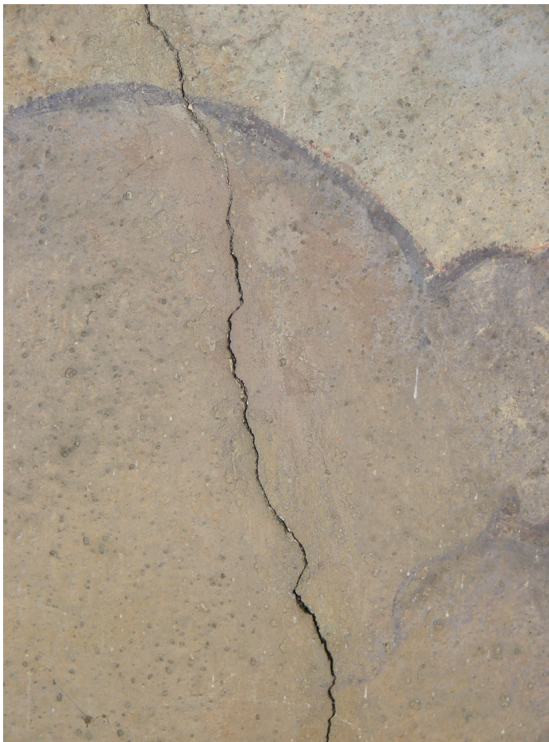
Obr. 16: Detail trhliny prostupující malbou. Foto: S. Běřáková.
