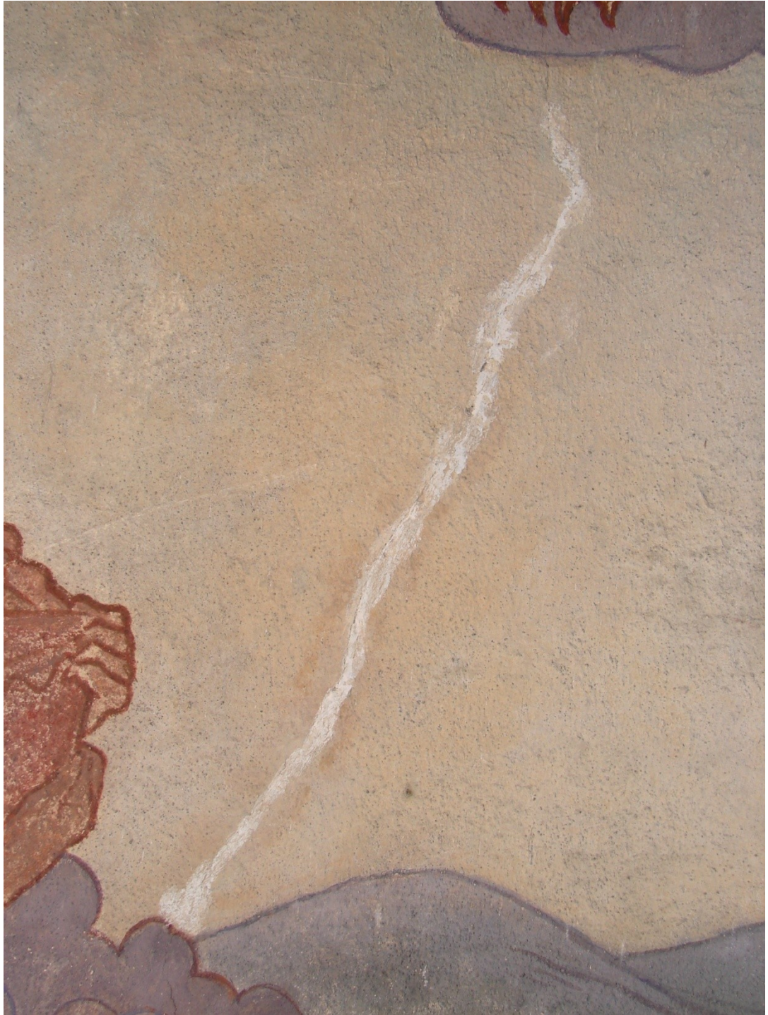
Obr. 32: Trhlina v malbě odhalená odstraněním druhotného sádrového tmelu. Foto: S. Běťáková.
