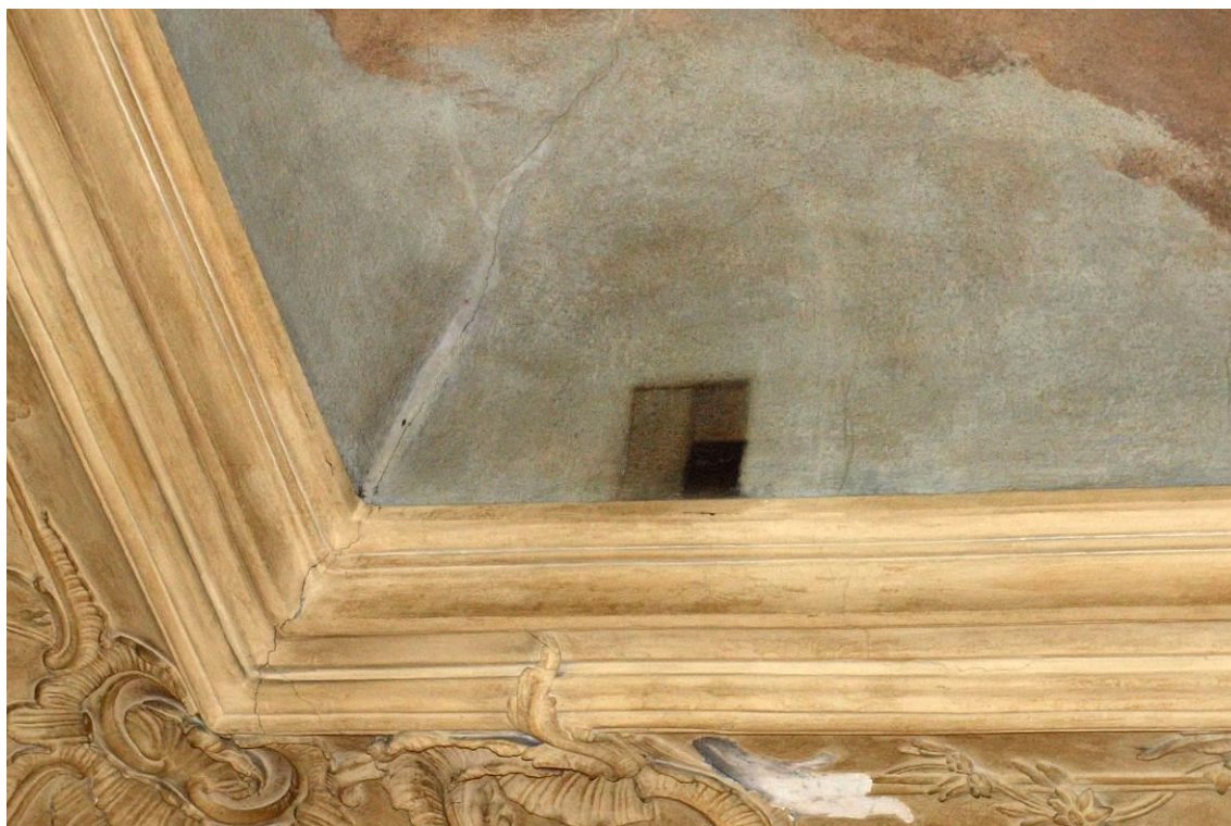
Obr. 139 Václav Bernard Ambrozi. Palác Sylva-Taroucca Na Příkopěch v Praze. Schodiště. Mytologický výjev s Aurorou a alegoriemi počasí a ročních období , fresco-secco – detail referenční plochy znečištění před restaurováním v 60. letech 20. století.
