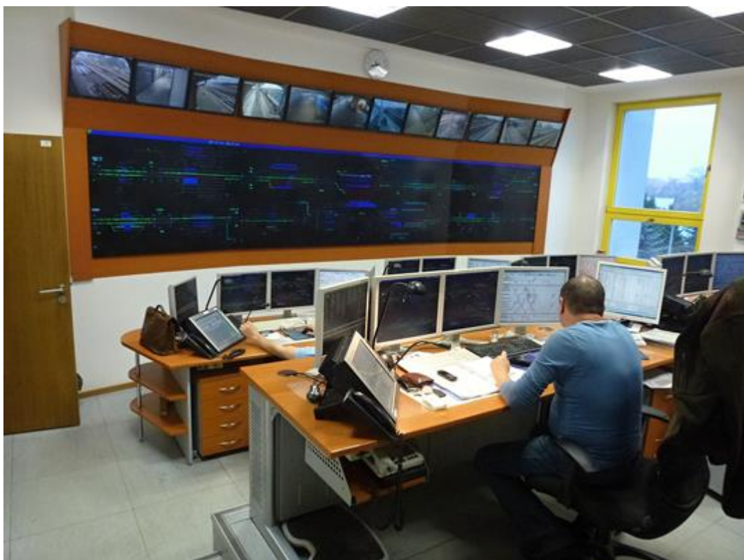
Obrázek 3 Dopravní sál 1 – pracoviště řídicího dispečera
