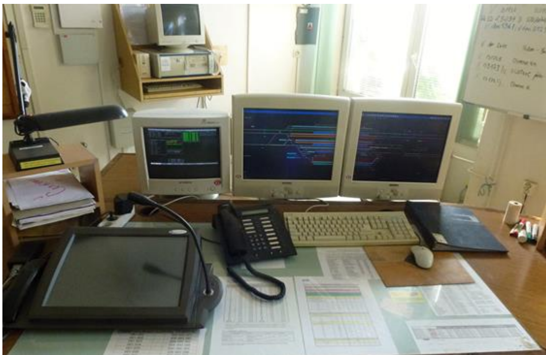
Obr. 8 Pracoviště výpravčích v žst. Hranice na Moravě
