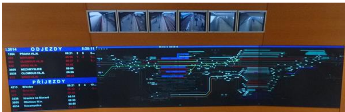
Obr. 3 VEZO včetně kamer v dopravním sále 4 – CDP Přerov
