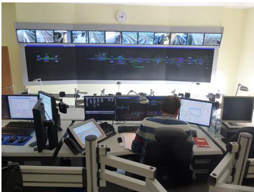
Obrázek 10 Dopravní sál 5 – pracoviště řídicího dispečera
