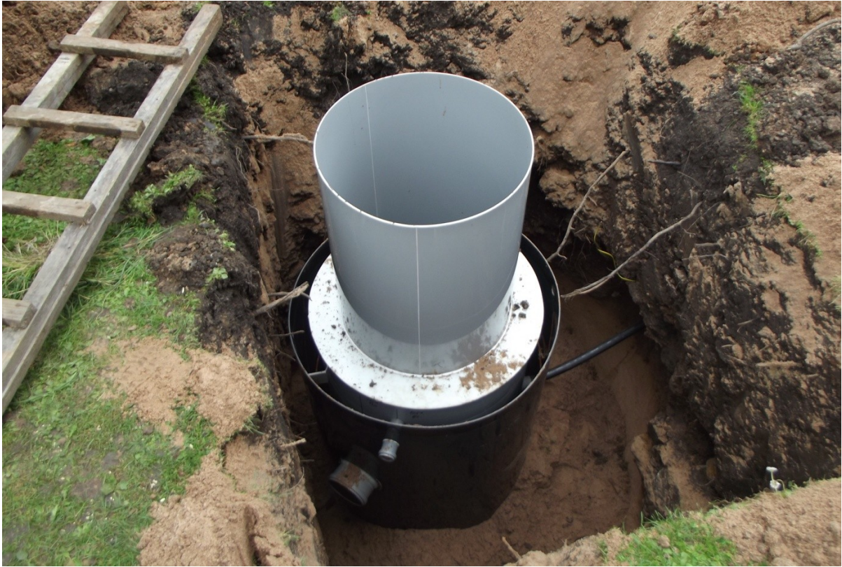
Jímka s domovní čerpací stanicí uvnitř
