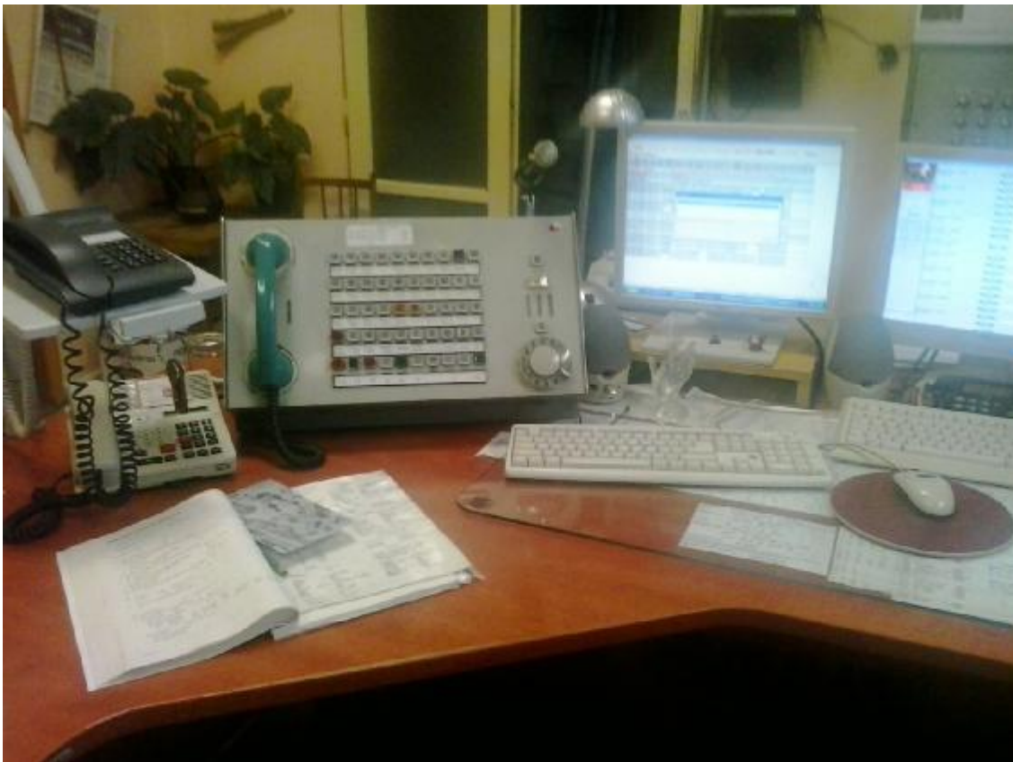
Obrázek 11. Pracoviště výpravčího v ŽST Úpořiny
