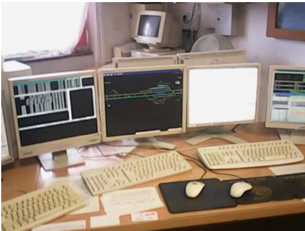
Obrázek 7: Pracoviště výpravčího v ŽST Teplice v Čechách Zdroj: (11)
