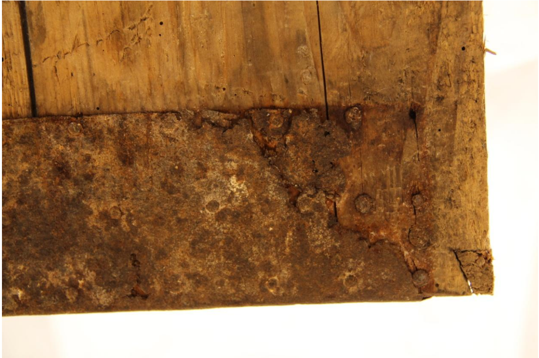
Obr. 204: Detail chybějící části železného plechu na spodní straně vpravo
