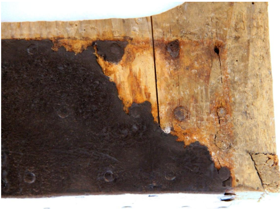
Obr. 205: Detail chybějící části železného plechu na spodní straně vpravo, kov po tanátování
