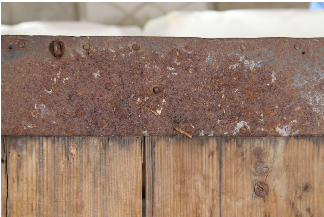
Obr. 198: Detail železného plechu na pravé boční straně se silnou korozí
