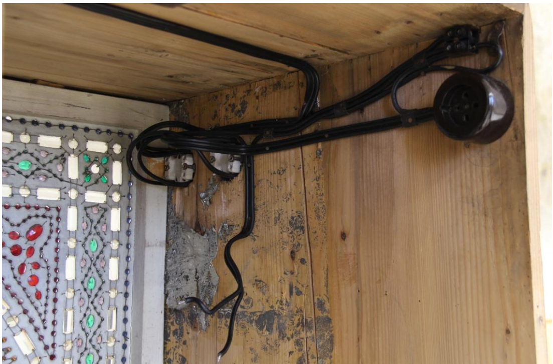
Obr. 170: Detail elektrického vedení a fragmenty alobalu na pravé straně před restaurováním
