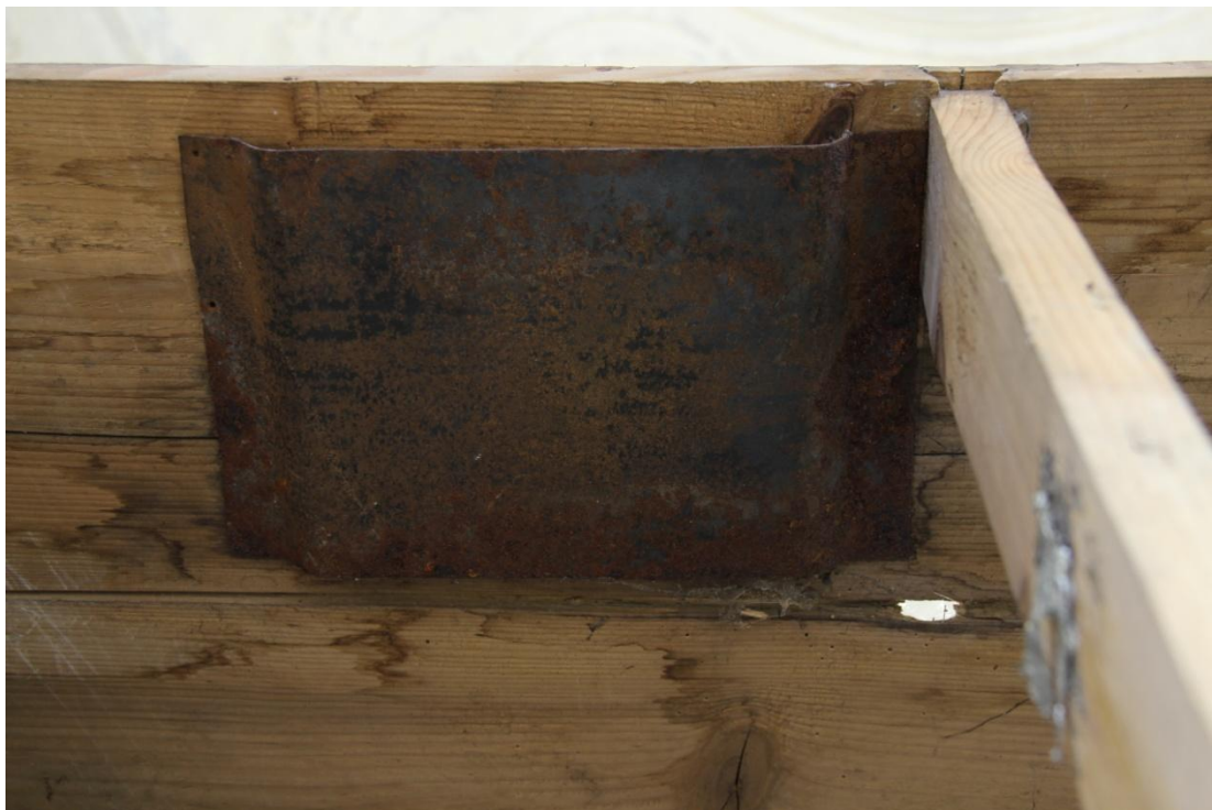
Obr. 201: Detail železného plechu na spodní straně horní desky, poškození korozí
