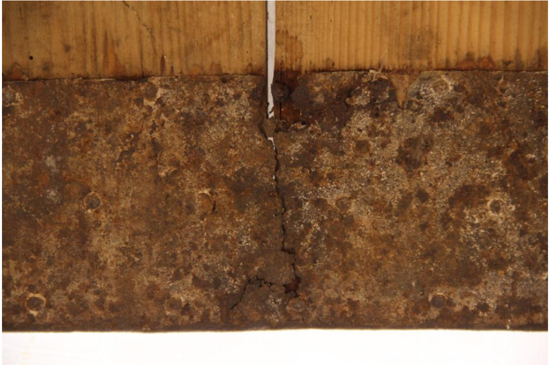
Obr. 206: Detail praskliny v železném plechu, poškození vzniklé korozí
