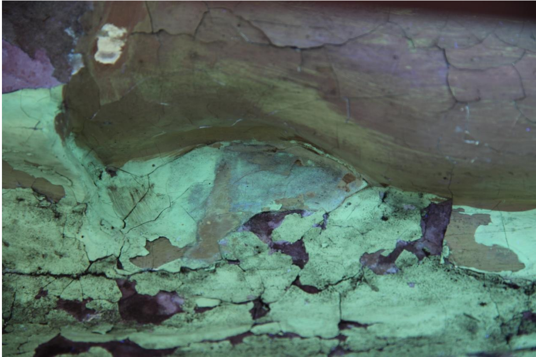
Obr. 50: Stratigrafická sonda v místě poškození barevné a křídové vrstvy, UV luminiscence
