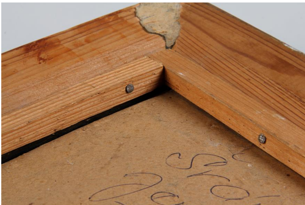
Obr. 4.3 Stav před restaurováním, detail, zadní strana
